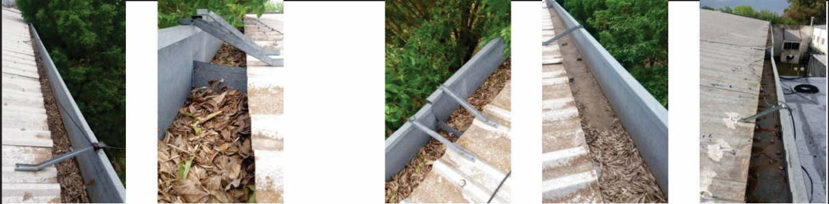
Estado general de canaletas - Este obstruida / Oeste limpia
