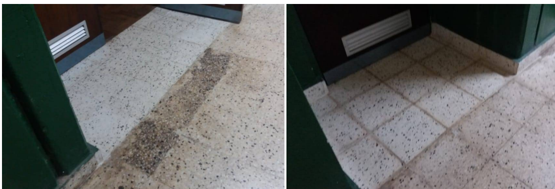
Unión de solados de granito de distintas etapas en Pasillo de Planta baja.
