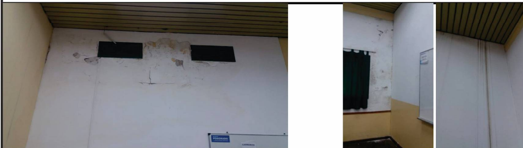
Ingreso de agua en PA por puntos de interfaz constructiva (distintos puntos de ingreso en cubiertas de aulas en PA)
