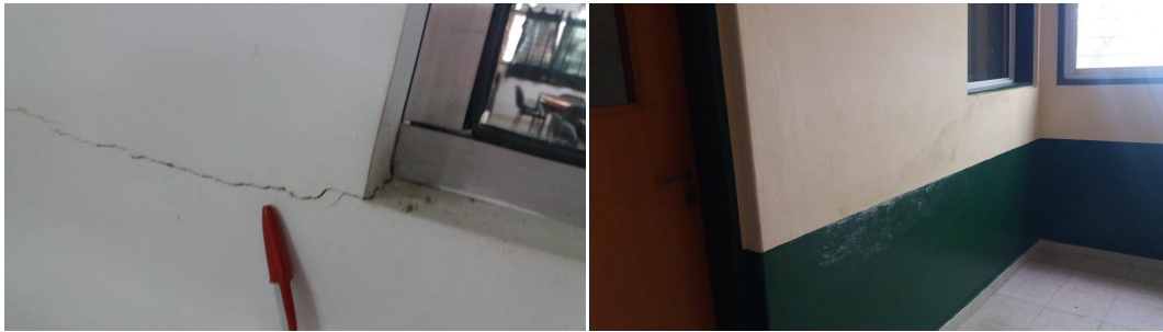
Ala izquierda – Fisura en Biblioteca. A la derecha – Fisura en pasillo PA altura departamentos de grado (tratada).
