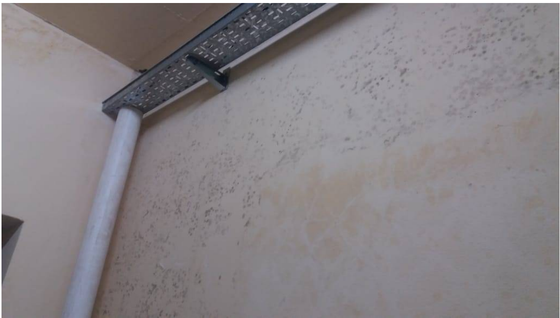
Manchas de condensación en extremo final de pasillo de planta alta, coincidente con punto de ingreso de agua.
