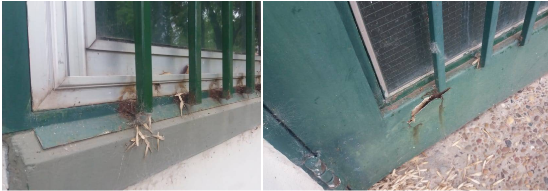
Corrosión en rejas de ventanas de aulas en Planta baja – puerta de ingreso secundario.
