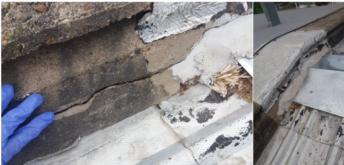
Fisuración y desprendimientos en carga de cubierta de chapa, en punto de interfaz entre aulas de planta alta y departamentos de grado
