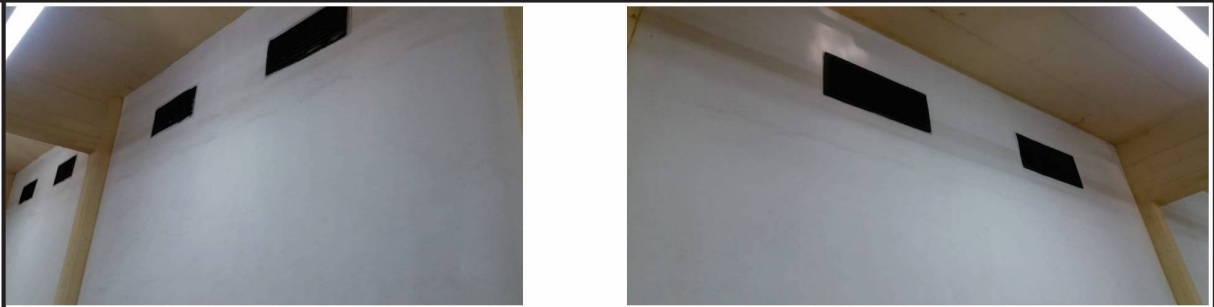
Condensación en PB coincidente con posible ubicación de viga estructural hacia pasillo de circulación técnica (ex ventilación con rejillas tapadas - ver que la misma situación no se produce en las aulas del otro lateral) - Aulas 3 y 4 PB
