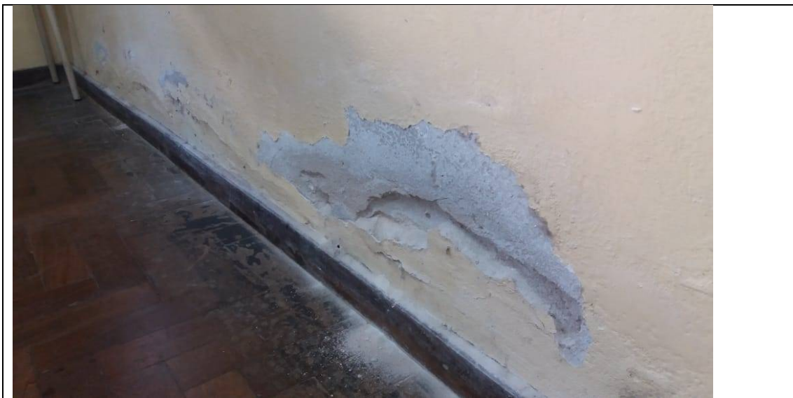
Humedad inferior localizada en una de las aulas de Planta baja – Ala Oeste
