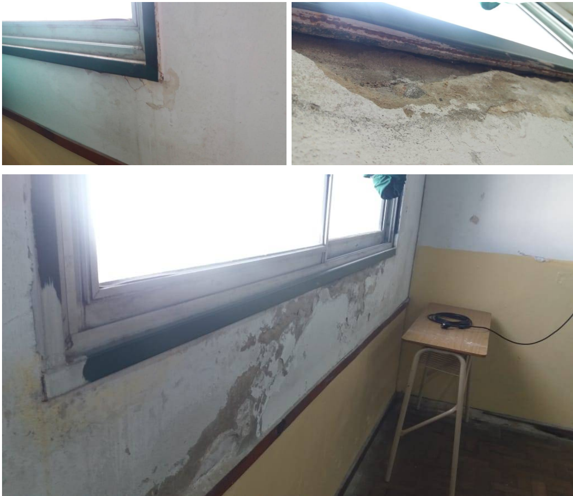
Ingreso de agua por aberturas en aulas de planta alta con vista hacia el patio interno.
