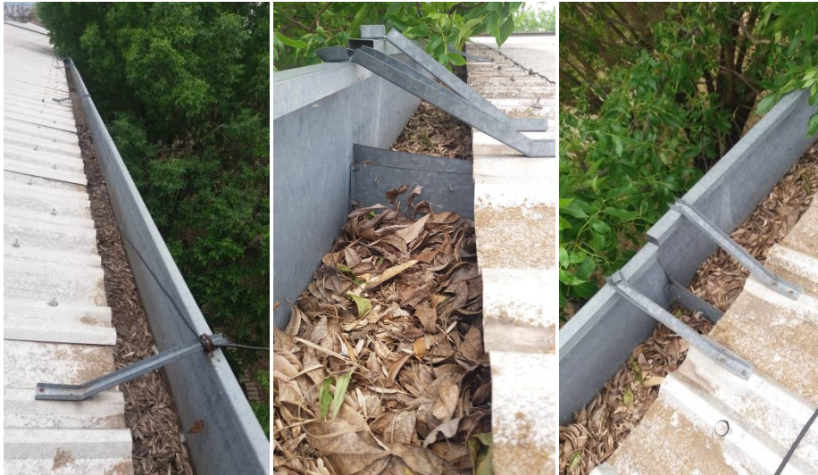
Canaletas obstruidas por vegetación en fachada oeste.
