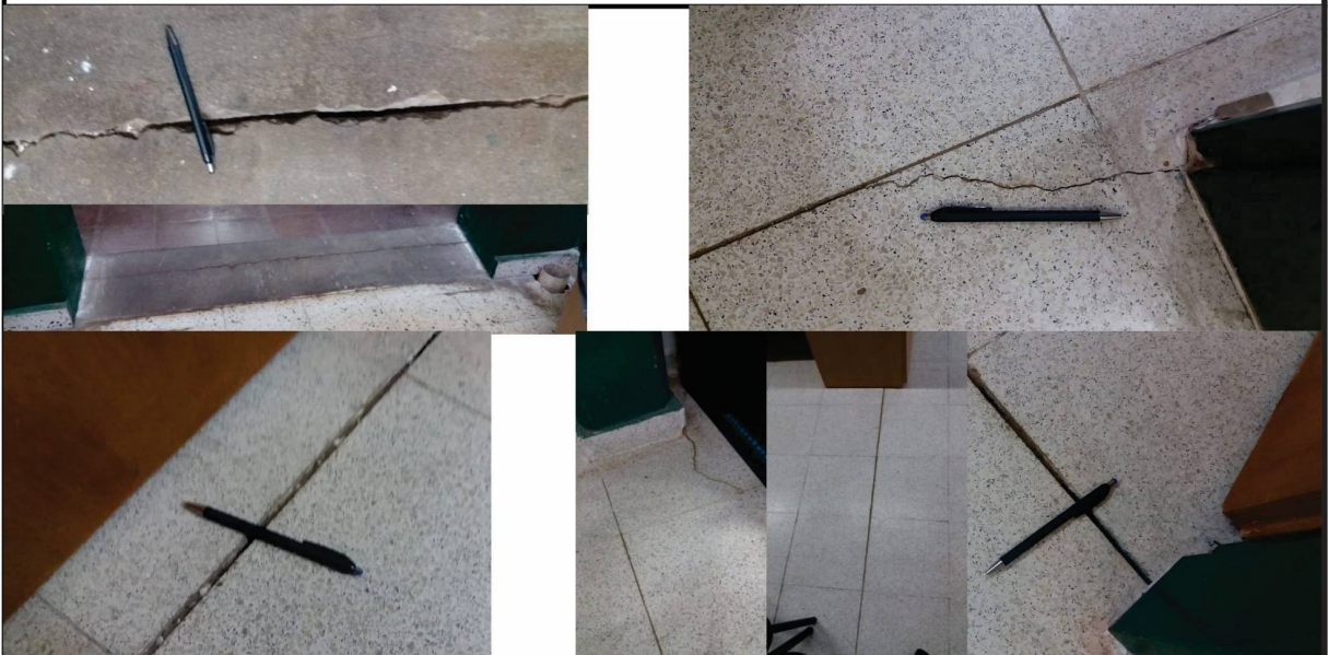
Fisuraciones coincidentes con interfaz constructiva (sector aulas y departamentos de grado) - Fisuras en sector de biblioteca y departamentos de grado, debido a los esfuerzos producidos por el hundimiento de la base.
