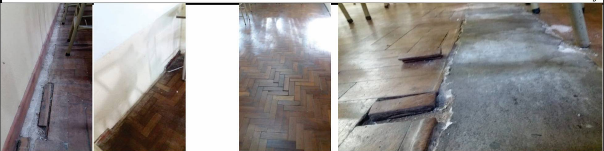
Solado de parquet en aulas: faltantes, desprendimientos, manchas, zócalos - Fotos aulas n° 1, 2, 3 y 10 PB
