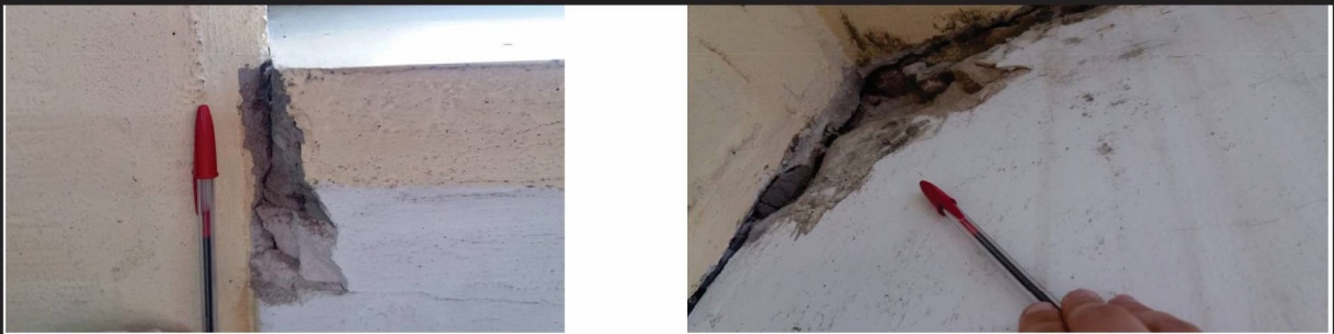
Desprendimientos producto de encuentros entre elementos estructurales y mamposterías -Situación observada en Aula 2 PB
