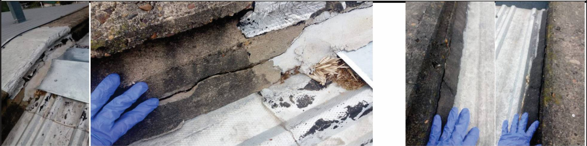
Carga fisurada - Carga de material en punto de separación entre bloque de aulas y sector de oficinas de grado (interface constructiva)
