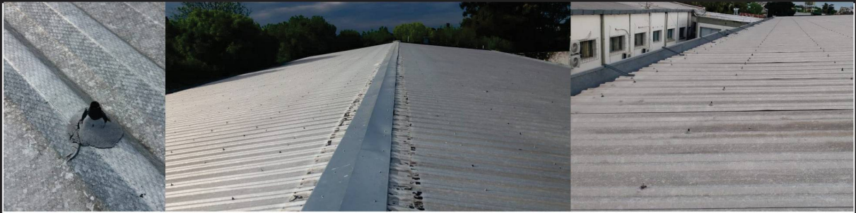
Estado general de las chapas y detalle de sellado en puntos de atornillado
