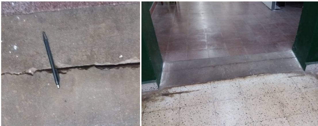
Fisura en solado - Planta alta: unión de pasillo de aulas y departamentos de grado.
