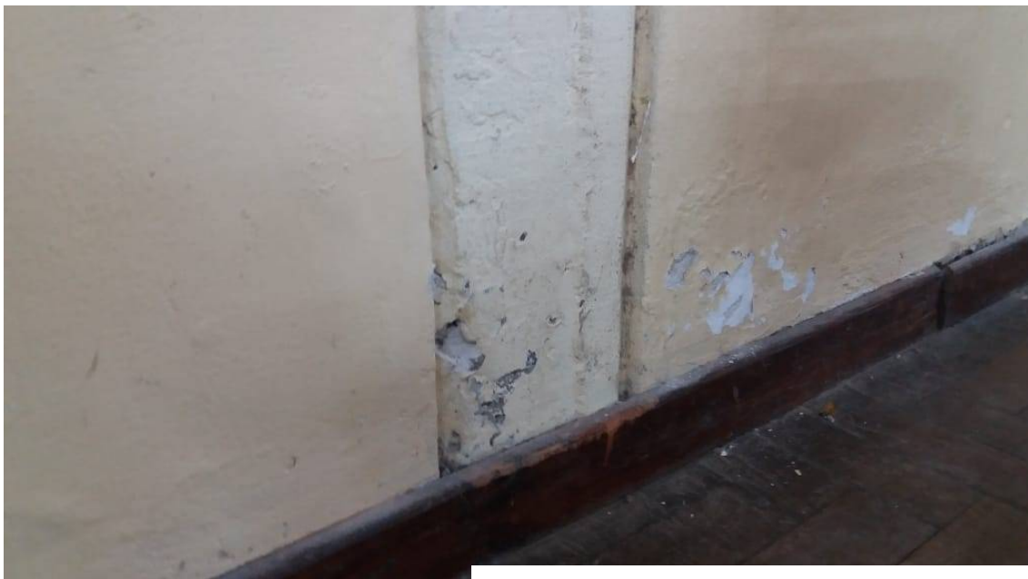
Columnas con desprendimiento de recubrimiento en aulas de planta baja
