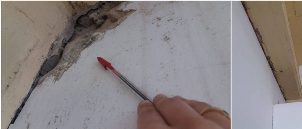
Fisura unión de muro de cerramiento y estructura de H º A º - Aula en Planta baja.
