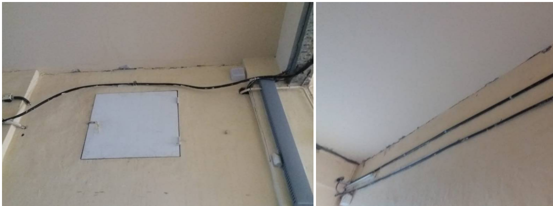
Fisura en unión de losa y muro - Planta baja: zona final de aulas y pasillo de salida previo a biblioteca.
