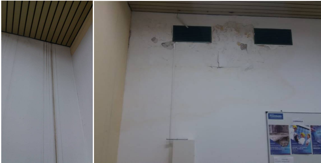
Filtraciones de agua superiores en aulas de planta alta
