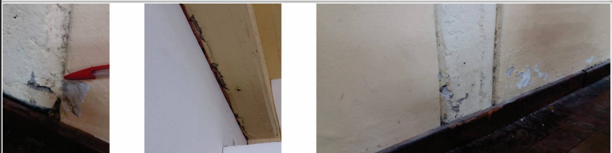
Desprendimiento de recubrimiento en columnas y vigas - Situación observada en Aula 2 PB
