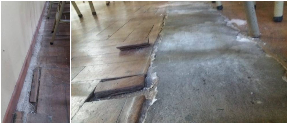
Piezas de solado sueltas, rotas o faltantes en aulas de Planta baja.
