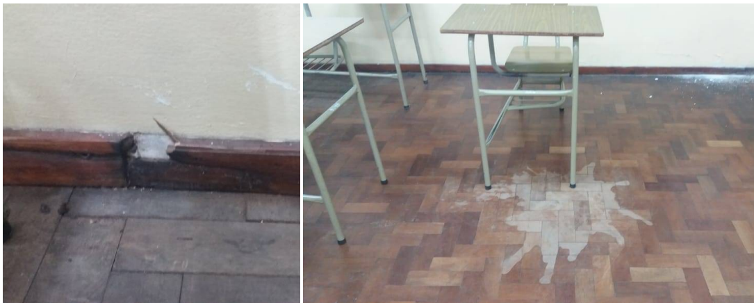
Piezas de zócalos rotas y manchas en solados de aulas de planta alta.
