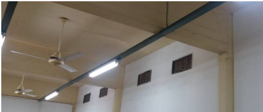
Posibles manchas de condensación, coincidentes con ubicación de estructura de hormigón armado, en muros divisorios de aulas de planta baja ala este, con
