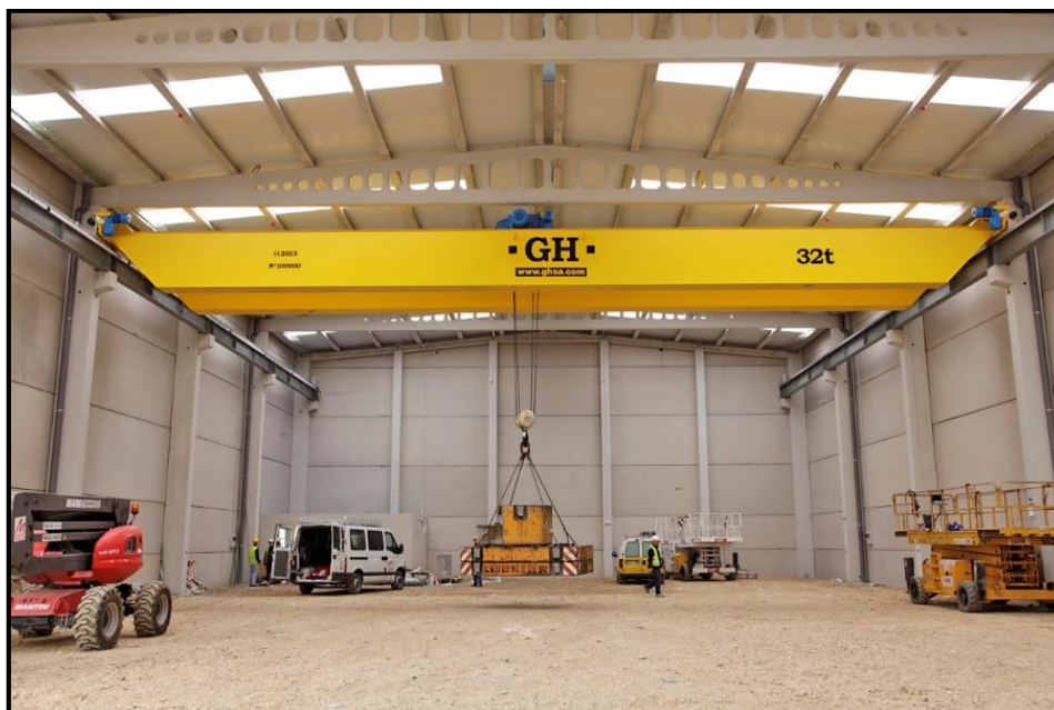
Figura 14: Puente grúa sobre nave industrial.
