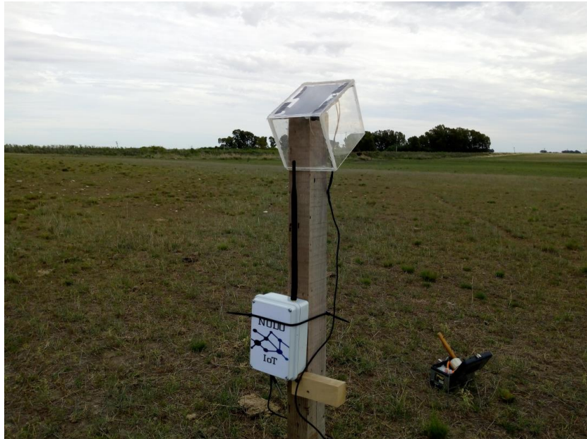
Figura 4.19: Instalación en campo del Nodo 3
