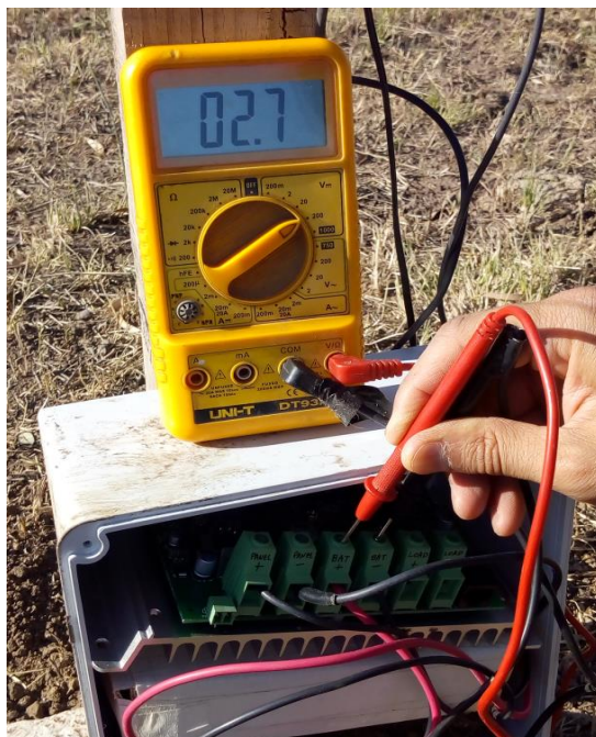
Figura 4.22: Nivel bajo de la batería AGM
