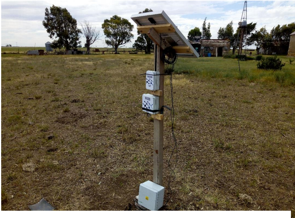
Figura 4.15: Instalación en campo del Nodo Gateway y el Nodo 1
