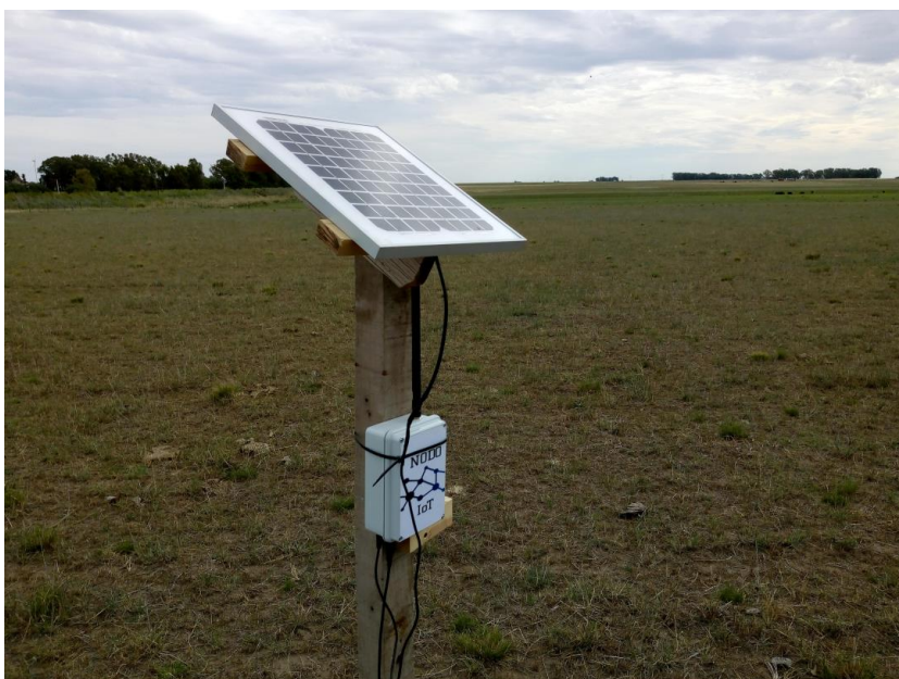
Figura 4.18: Instalación en campo del Nodo 2
