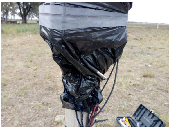
Figura 4.17: Vista cercana al nodo cubierto con nylon
