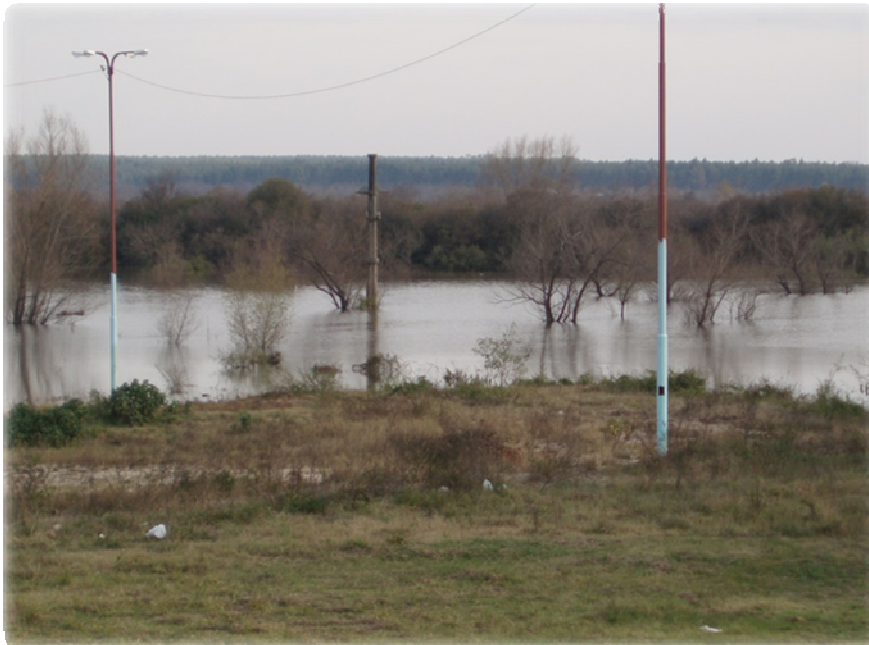
Estructura afectada por crecida de arroyo Yuquerí Grande
