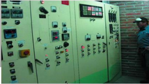
Foto: Un panel de control de una máquina doble husillo con alimentador lateral.
