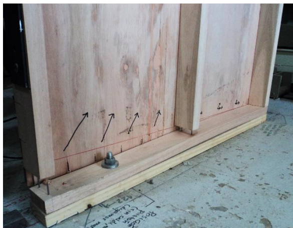
Figura 3 - Panel Es después del ensayo
