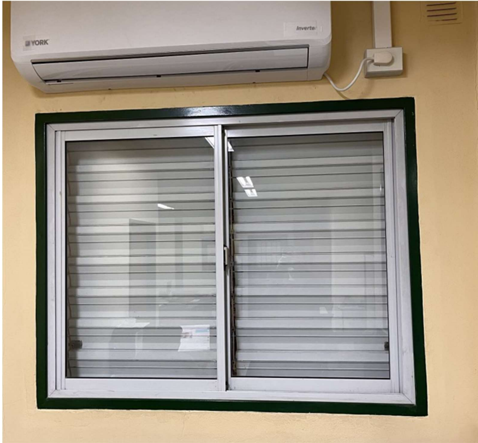
Figura 6.3.25: Recursos Humanos. Abertura vidriado simple y equipo de climatización
