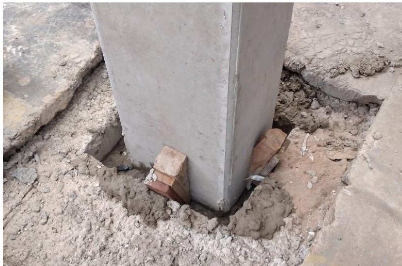
44- Colocación de una columna prefabricada con cuñas provisionarias hasta fraguado del hormigón
