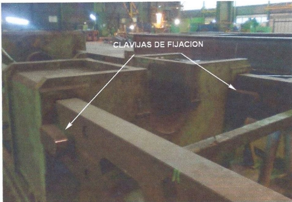
Fig. 3. Se observan las clavijas de fijación como se encuentran en la actualidad.
