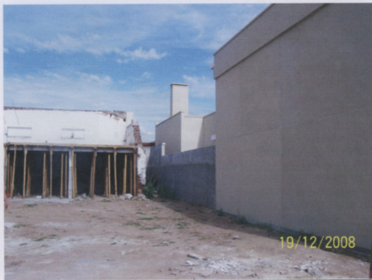
Medianera derecha, indica el espacio de 1.40m que se compro al vecino para que dieran las medidas reglamentarias de los patios.
