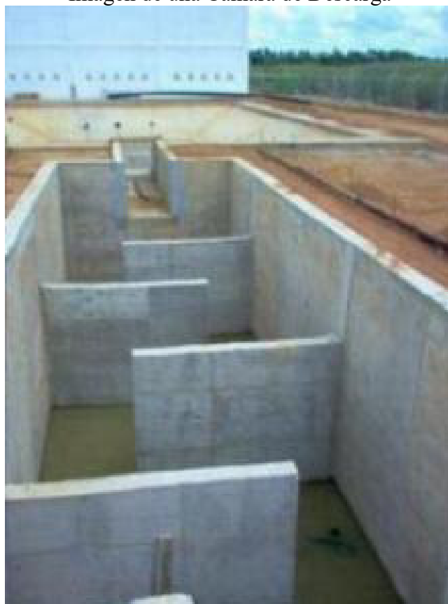
Imagen de una Cámara de Descarga
