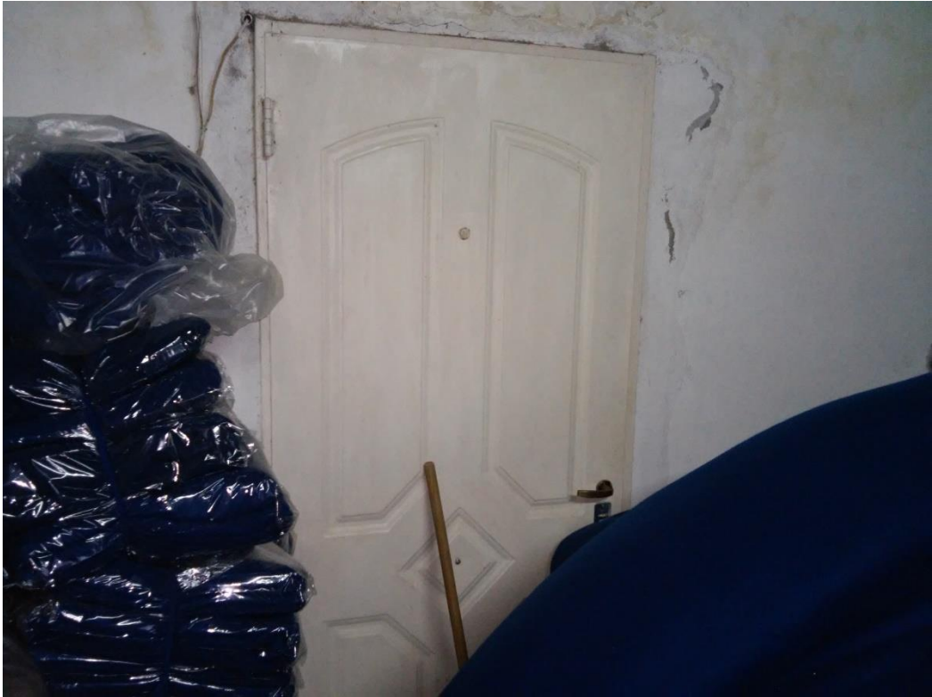
Foto 3: salida de emergencia bloqueada y sin señalar.
