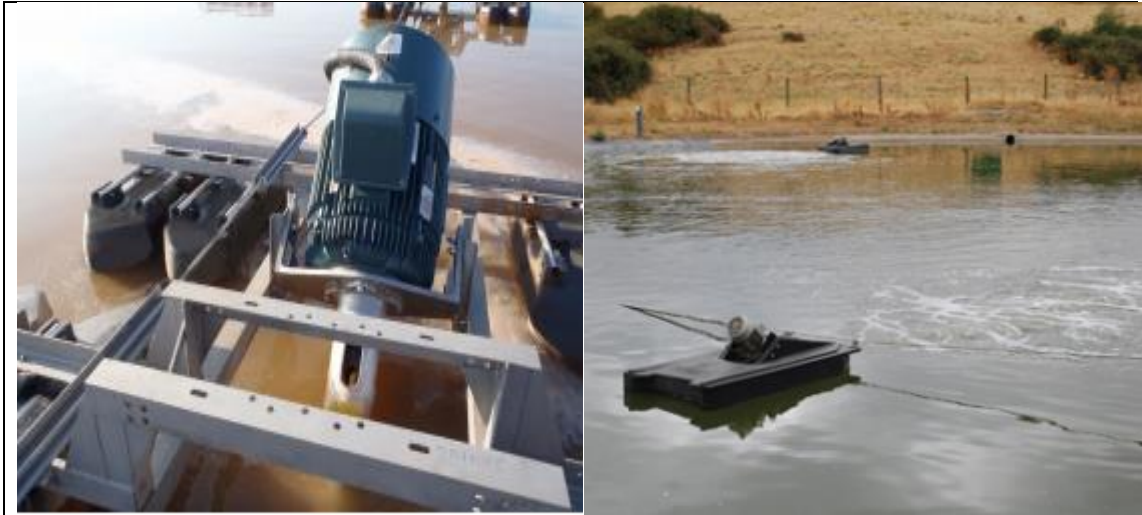
Figura 17. Aireadores en funcionamiento.
