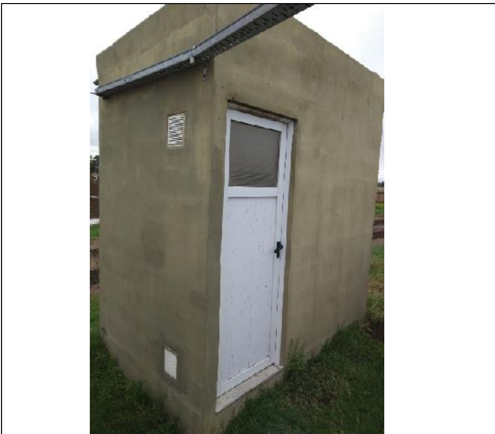
Figura 10. Estación de bombeo.
