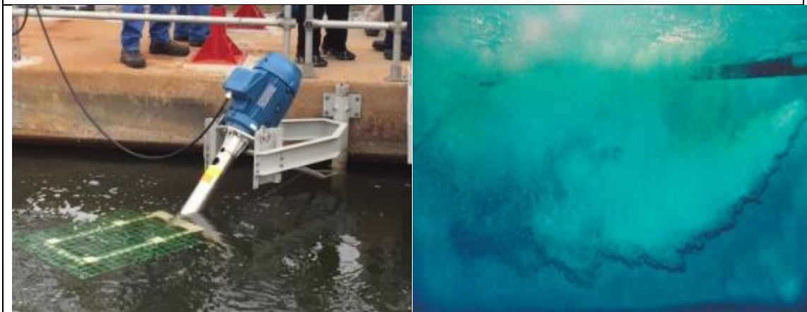
Figura 18. Vista debajo del agua de la capacidad de mezcla del aireador.
