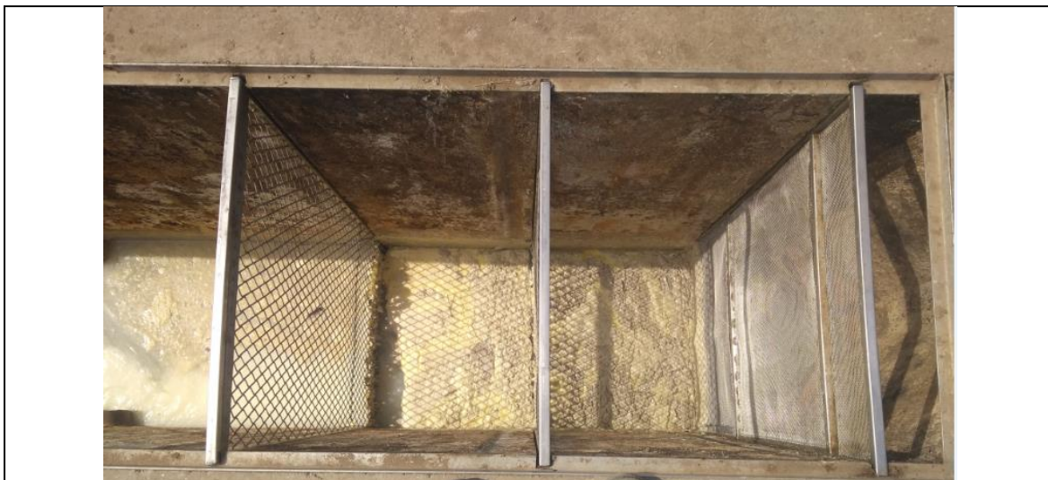
Figura 6. Vista de la cámara de rejas de frente.
