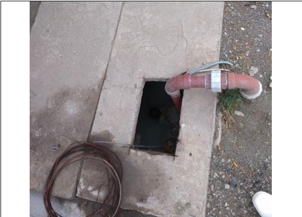
Figura 5. Vista de los caños de desague de los efluentes generados.
