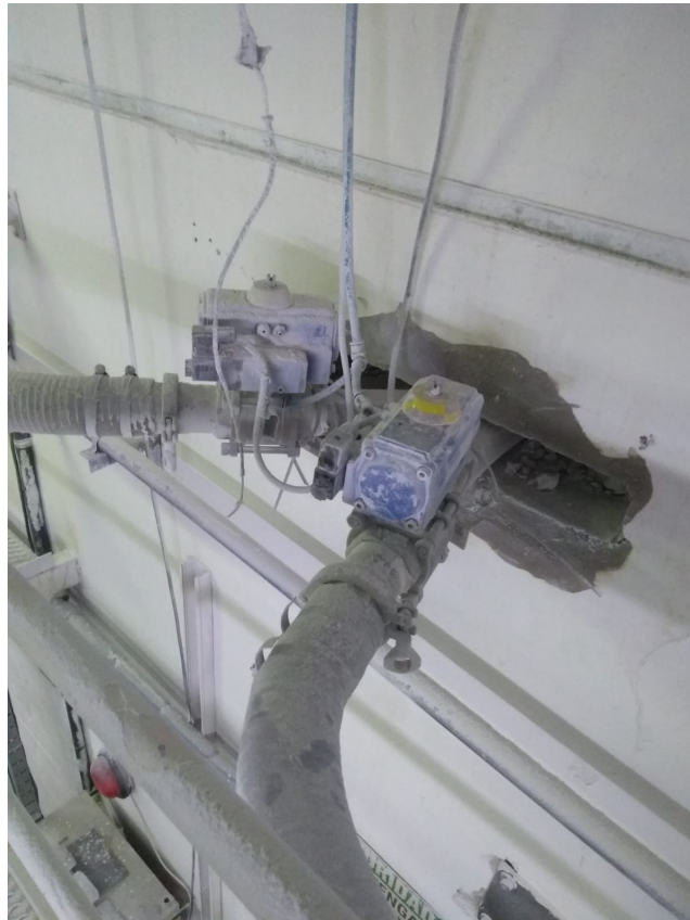
Figura 65: Válvula que permite el ingreso de azúcar impalpable desde la etapa de molienda al amasado
