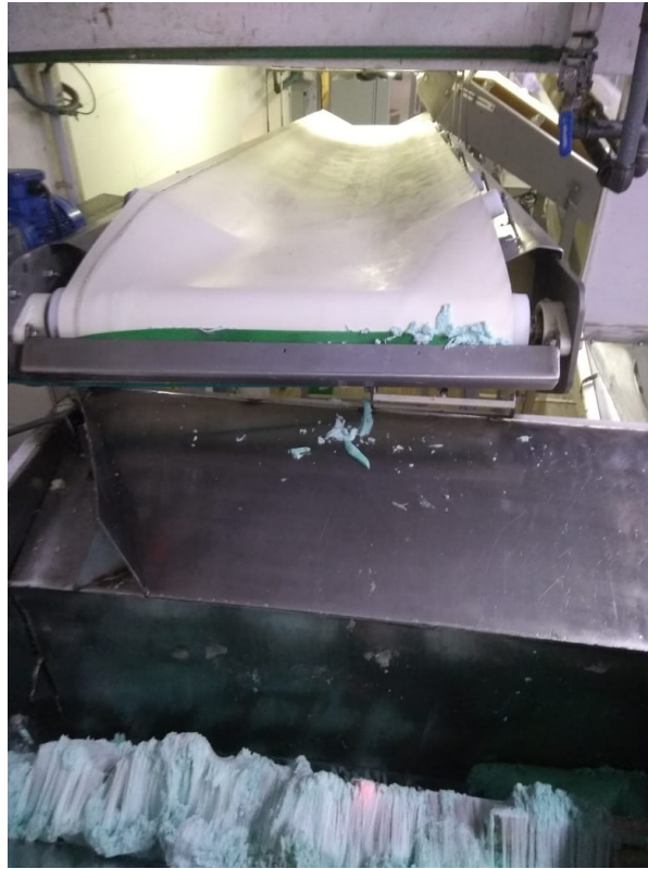
Figura 69: Cinta transportadora que traslada la masa hacia el extruder
