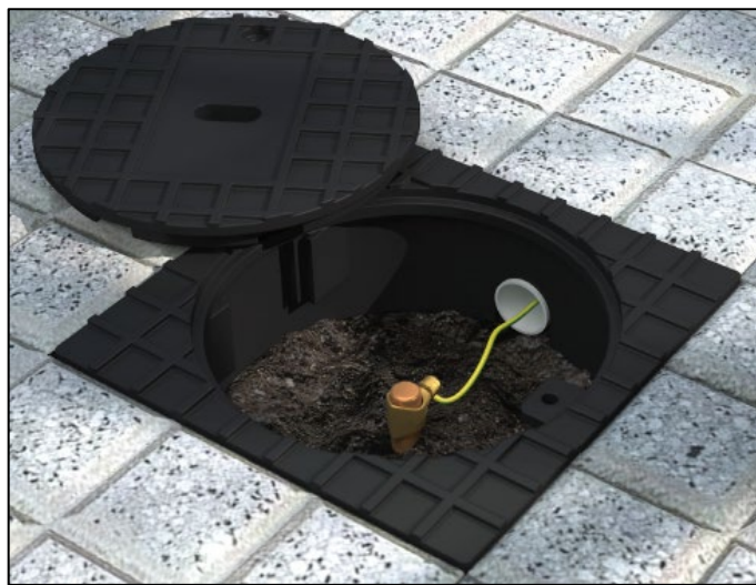
Figura 85.- Cámara de inspección de la puesta a tierra.
