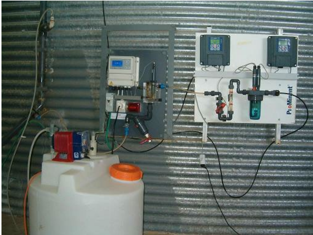
Fig. 12-49 Sistema de desinfección con hipoclorito de sodio. [N-49]
