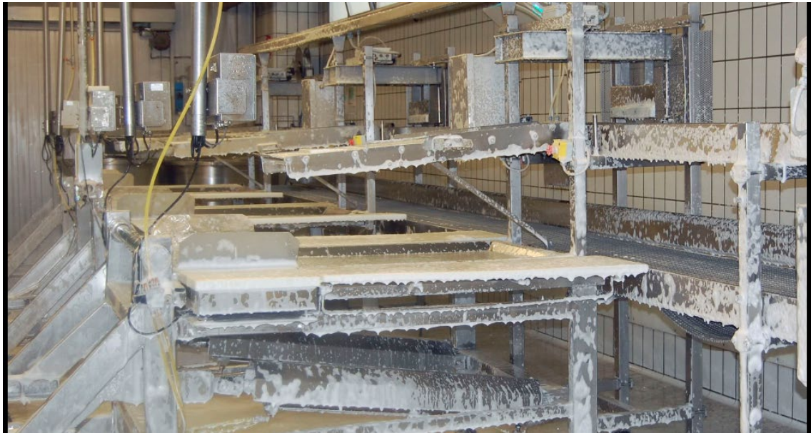
Fig. 1-43 Limpieza de cinta transportadora con aplicación de un limpiador mecánico. [ID-43]
