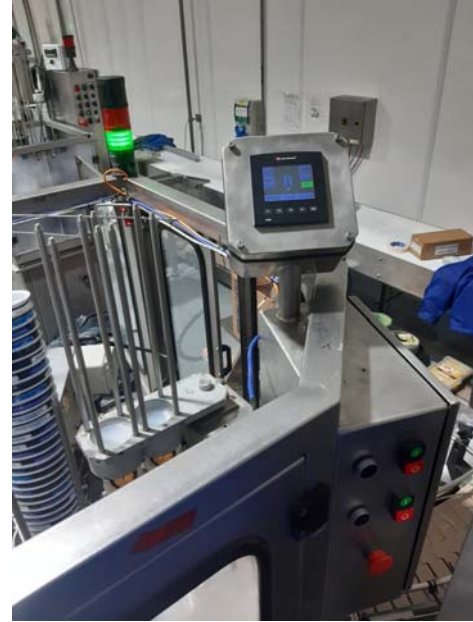
Fig. N° 35 Tablero PLC+HMI Final.
