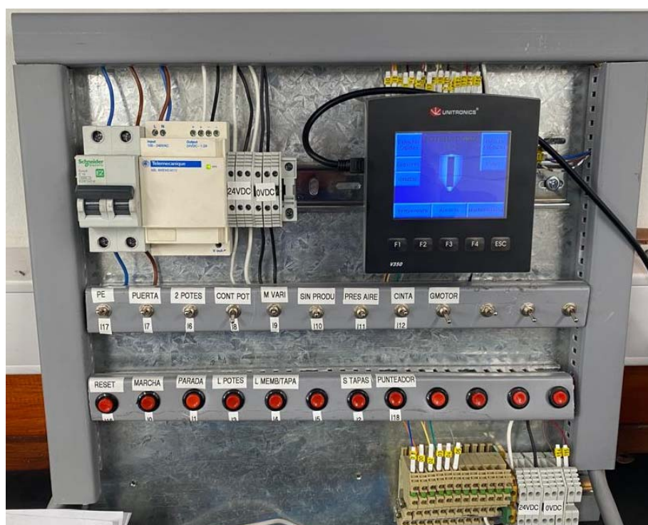
Fig. N° 21 Tablero experimental para emulación.
