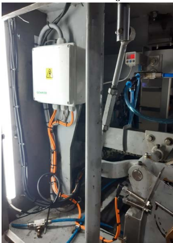
Fig. N° 38 Caja estanca de paso.
