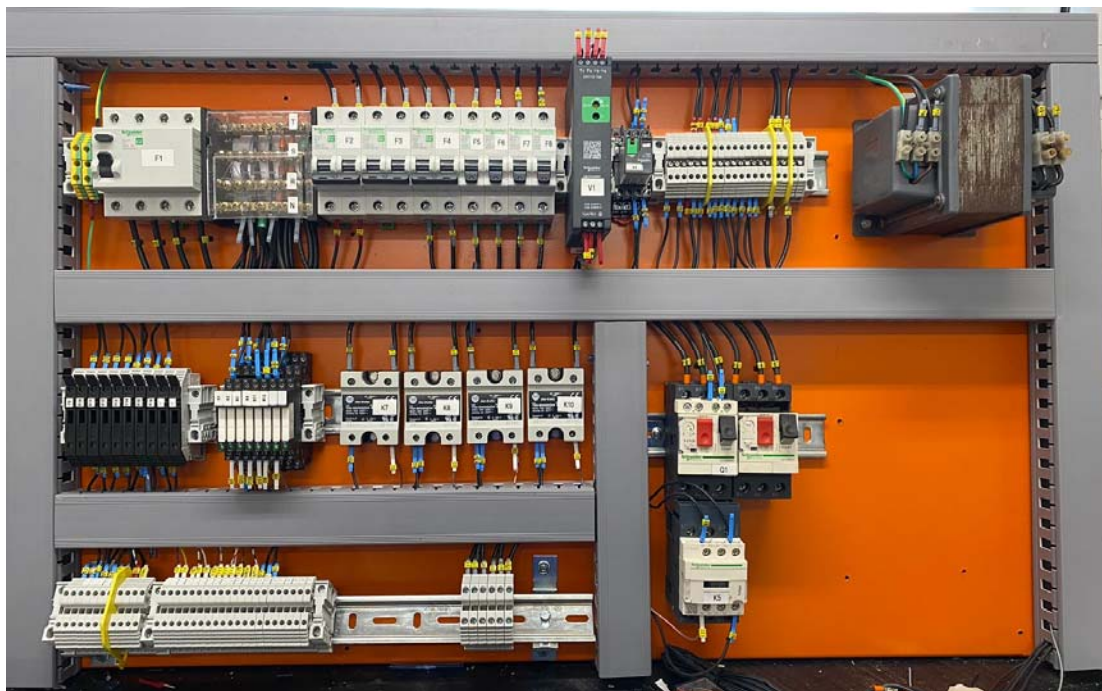
Fig. N° 33 Tablero eléctrico general final.
