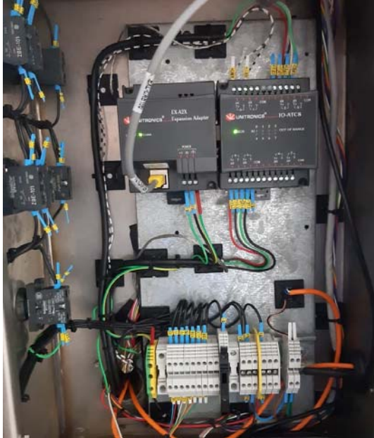
Fig. N° 34 Tablero Módulo Expansión I/O.
