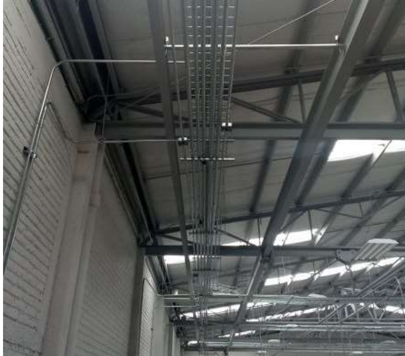
FIGURA 5.125 INSTALACIÓN ELÉCTRICA A LA VISTA.
