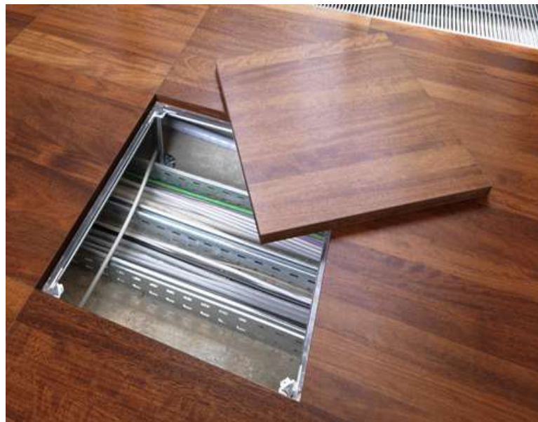
FIGURA 5.94 INSTALACIÓN ELÉCTRICA BAJO PISO TÉCNICO.
