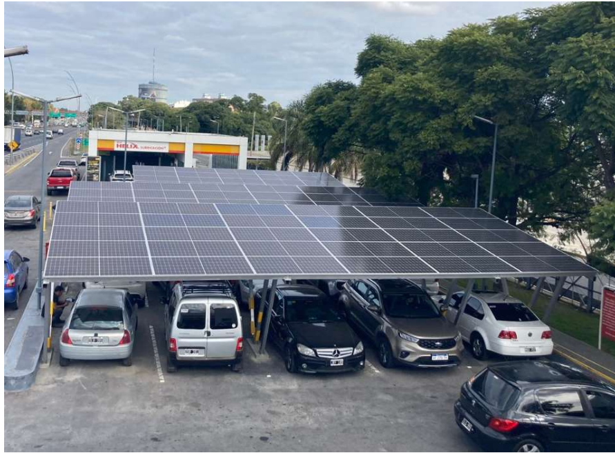
FIGURA 5.107 EJEMPLO CARPORT SOLAR – BUENOS AIRES.
