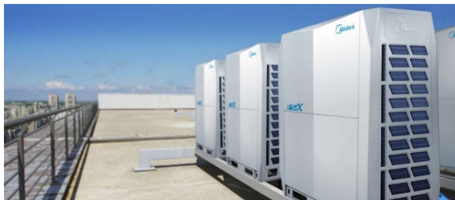
FIGURA 5.82 UNIDADES EXTERIORES - SISTEMA VRF.
