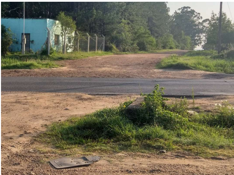
FIGURA 4.27 MAL ESTADO DE ALCANTARILLAS.
