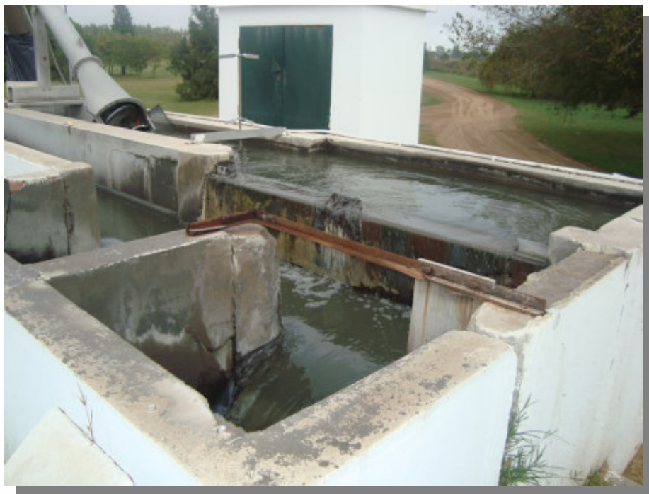
Separador de sólidos
