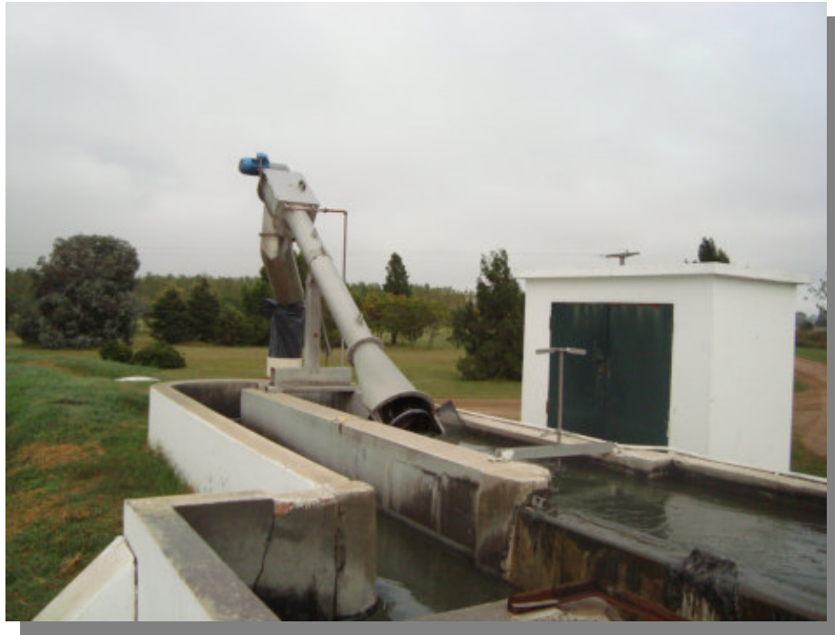
Separador de sólidos
