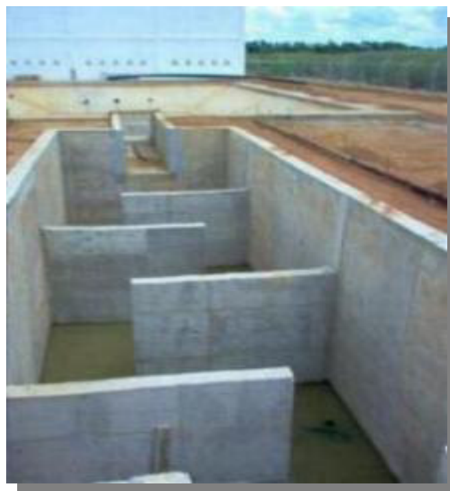
Imagen de una Cámara de Descarga
