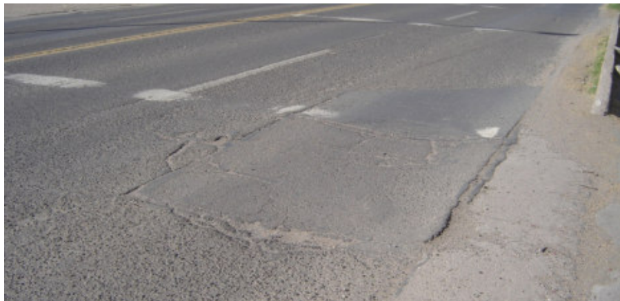
Foto 16 – Estado del pavimento.
