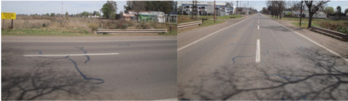
Figura 3 - Fisuras transversales medias (selladas)
