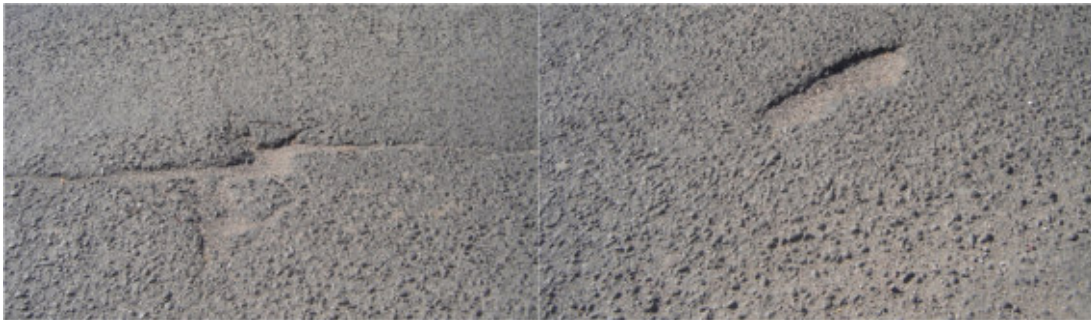
Figura 7 - Peladuras de Alta Severidad
