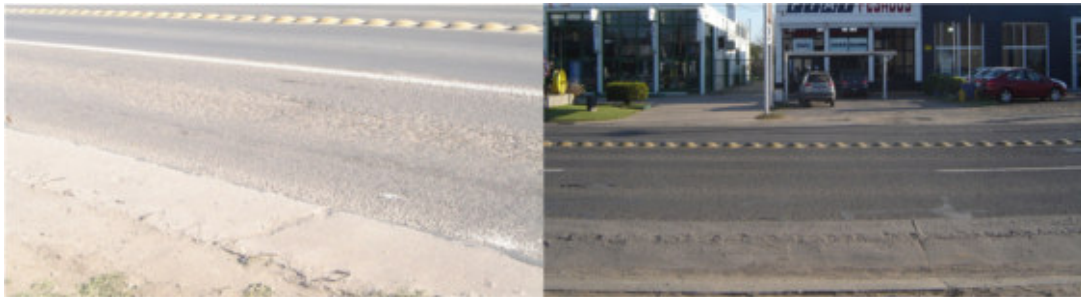
Figura 6 - Peladuras de media Severidad
