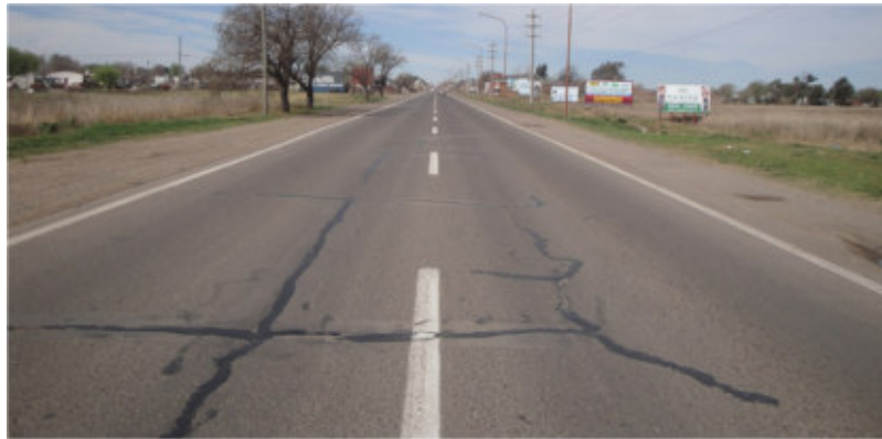
Figura 4 - Fisuras Longitudinales (selladas)
