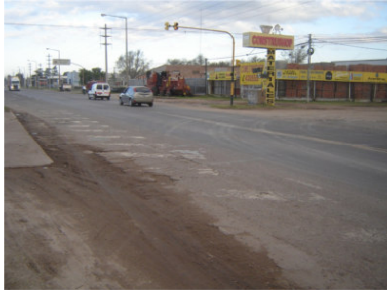
Figura 2 - Fisura de bloque alta severidad
