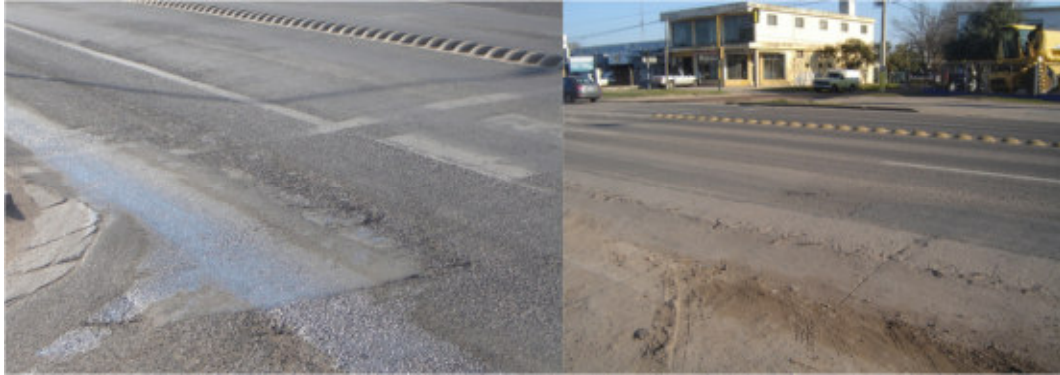
Figura 8 – Bacheo de severidad baja
