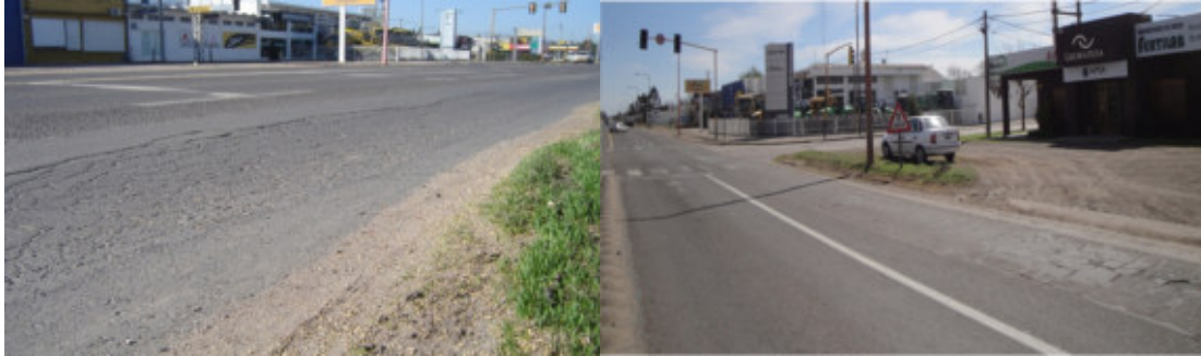
Figura 1 - Piel de cocodrilo, con nivel de severidad Media
