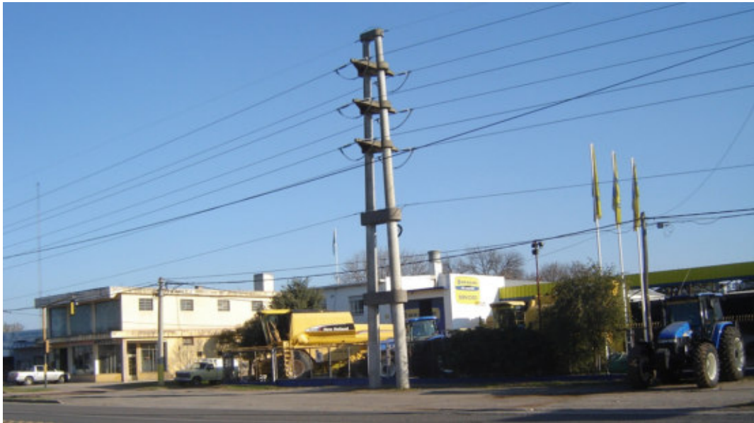
Foto 14 – Tendido eléctrico de alta tensión.
