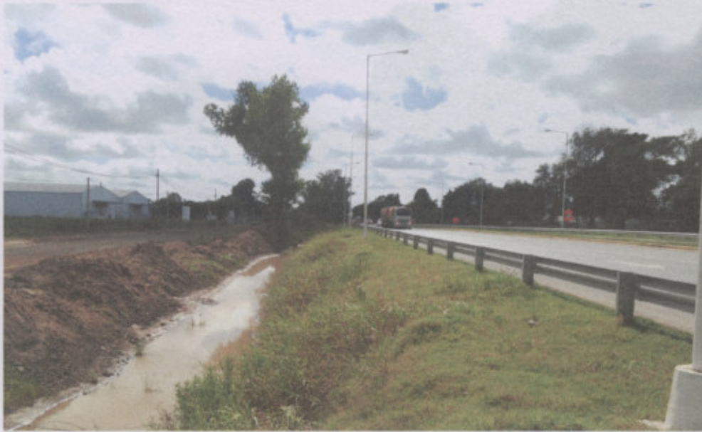
Intersección Av. Chapuis y RN N°33. Estado de cuneta actual
