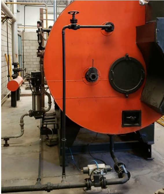
Purga de la caldera
