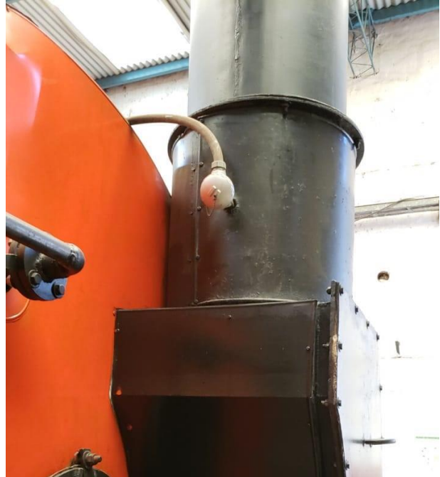
Control de temperatura de chimenea
