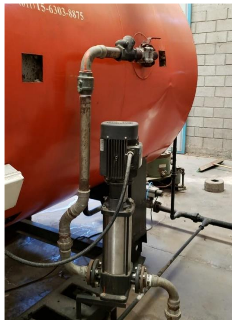
Ingreso de agua a la caldera
