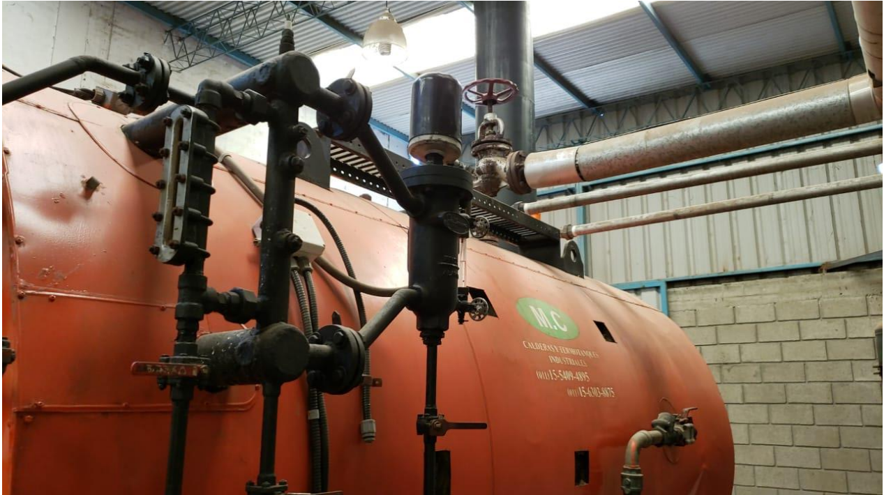
Indicador de nivel en caldera
