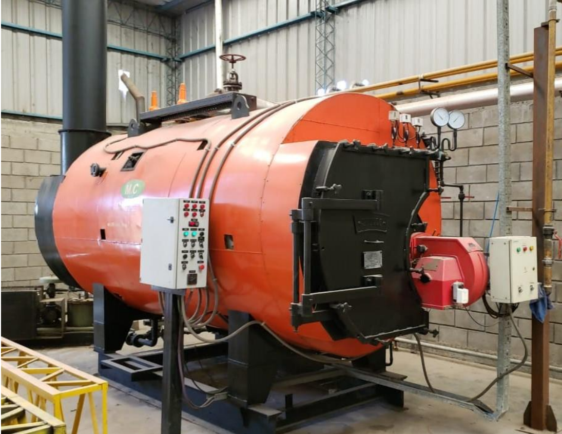
Caldera generadora de vapor
