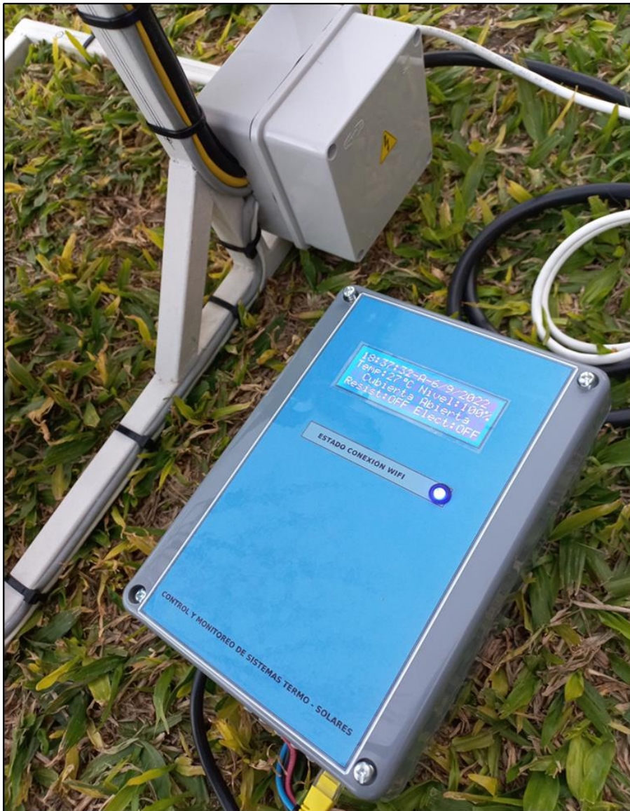
Figura 99: Vista del dispositivo en funcionamiento.
