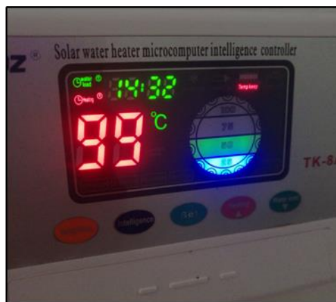
Figura 8: Temperatura alcanzada de un sistema termosifónico.
