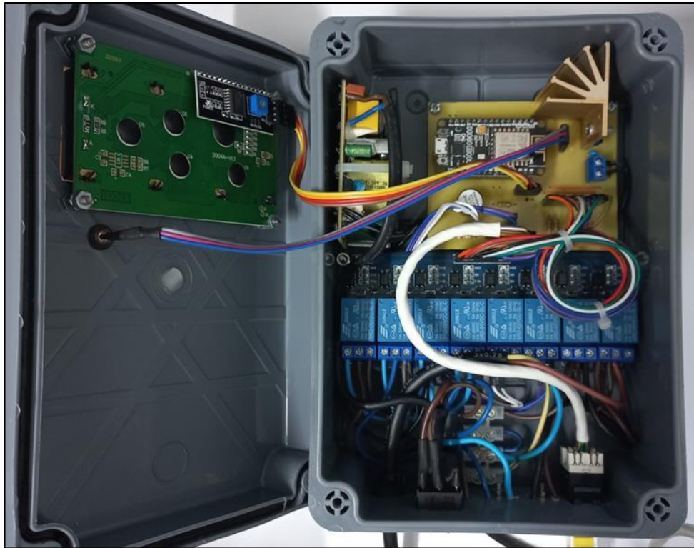
Figura 94: Vista del conexionado interior y sus componentes.
