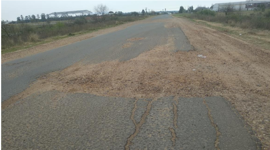
Figura 4-7. Fisuras longitudinales, piel de cocodrilo y bacheo. Fuente: Autoría propia
