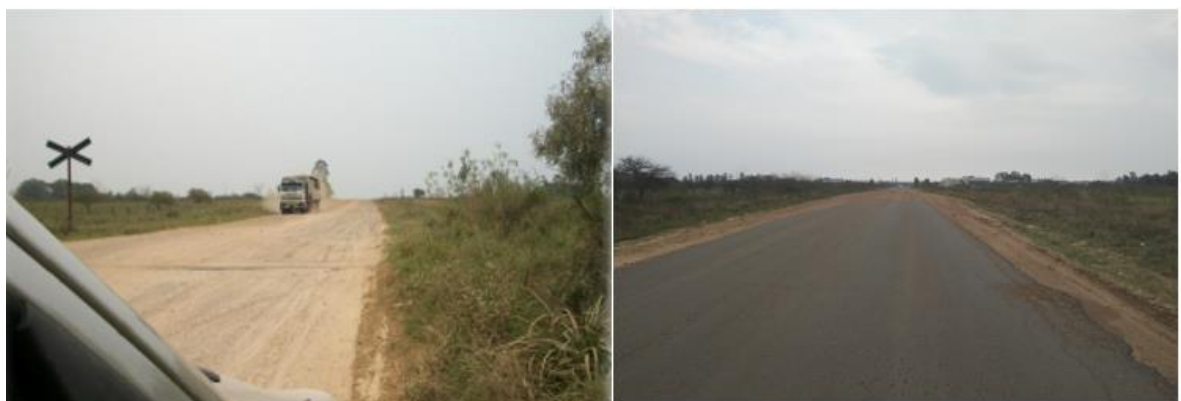
Figura 4-6. Foto Izquierda fin de asfalto y derecha fisuras en bloque.
