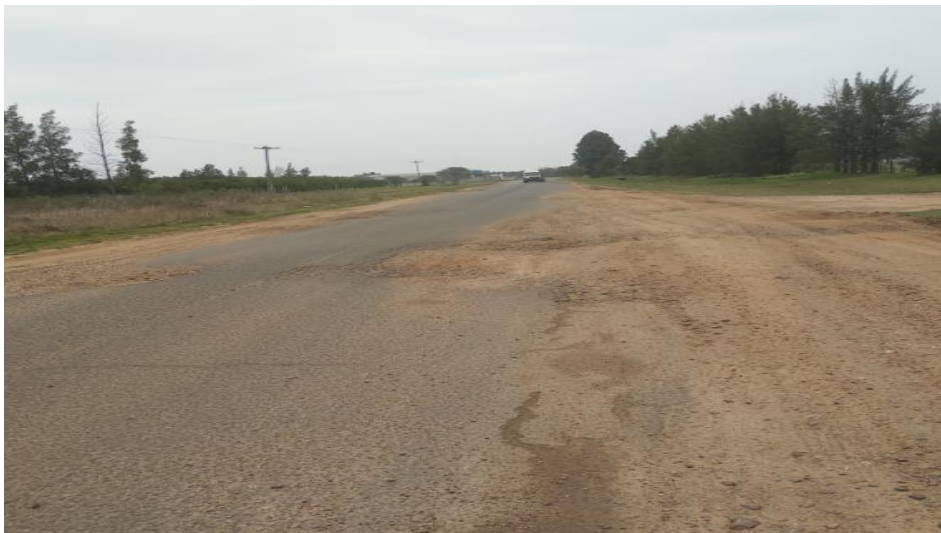
Figura 4-8. Calzada de pavimento angosta. Fuente: Autoría propia
