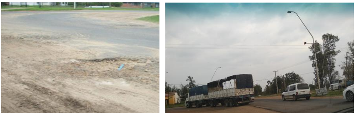
Figura 4-3. Deterioro intersección Av. Belgrano y Ruta Tres Hermanas
