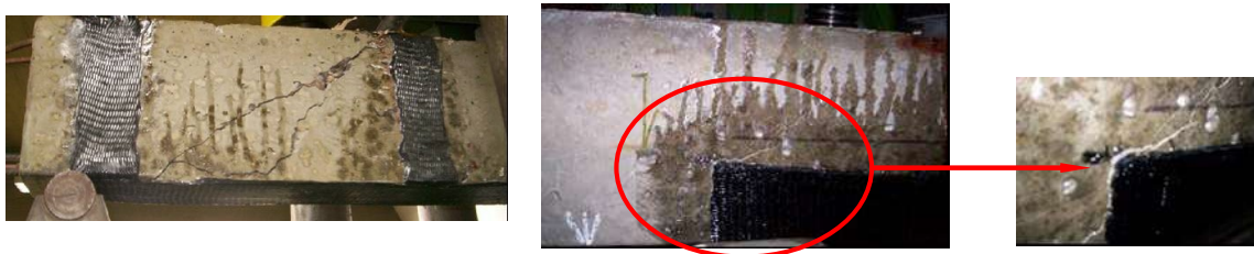
Figura 8. Tipo de falla de vigas no reparadas y vigas dañadas y reparadas con PRFC.
