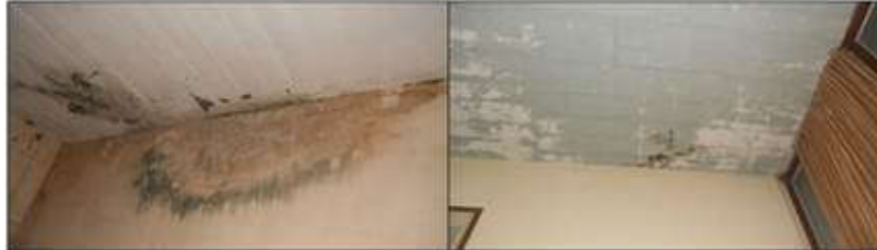
Figura 8: Lixiviación y filtraciones de agua de lluvia (izq.) y Filtraciones de agua en losa sobre 2do piso (der.).
