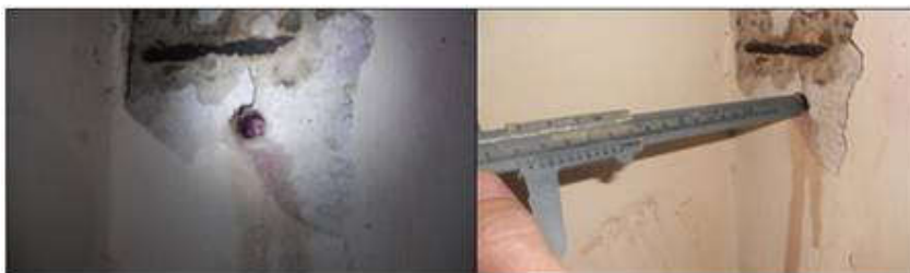
Figura 13: Aplicación de fenolftaleína en columna 2do piso (izq.) y Medición de carbonatación (der.).
