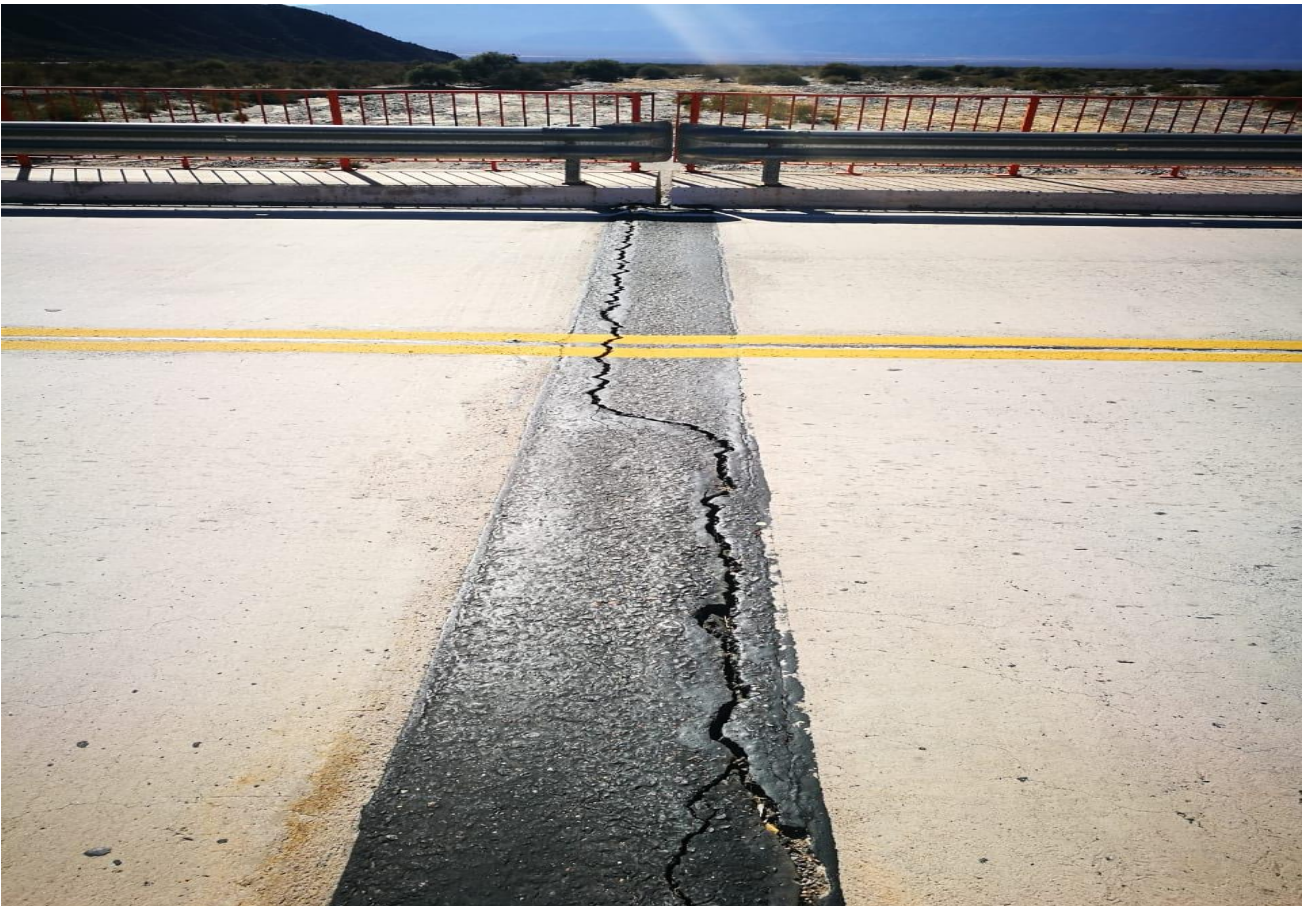
Fig. 15 junta dilatación tramo central
