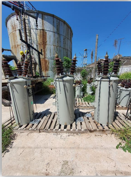
(Transformadores Trifásicos de 16 kVA; 13,2/0,4-0,231 kV)
