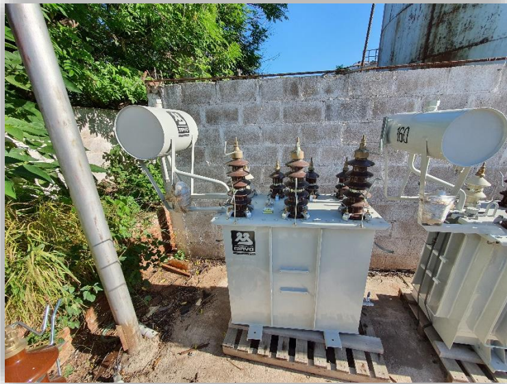
(Transformador Trifásico de 100 kVA; 33/13,86-8 kV)
