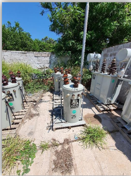
(Transformadores Trifásicos de 25 kVA; 13,2/0,4-0,231 kV)
