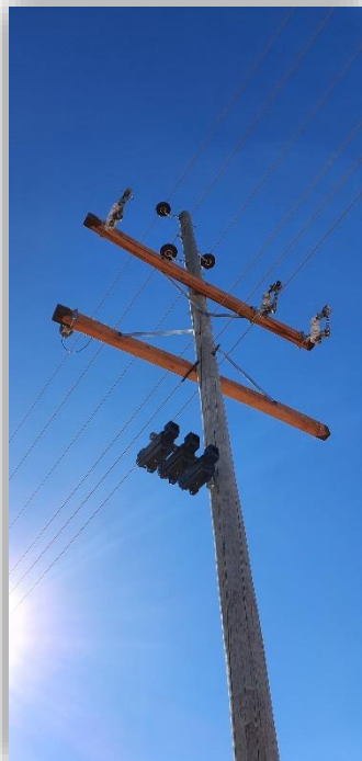
[Apoyo de alineación LMT en ejecución, falta el transformador, se observan los seccionadores XS (blancos) y los seccionadores APR (negros) donde se alojan los fusibles NH]
