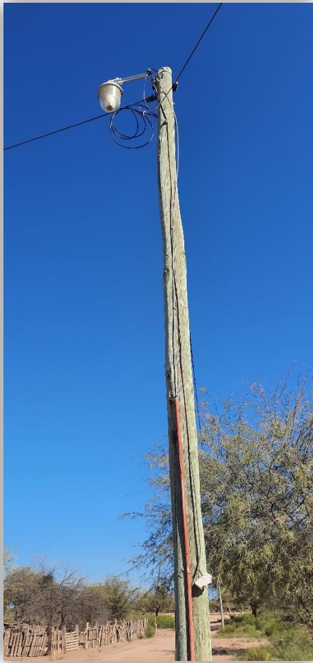
(Luminaria accionada mediante llave termomagnética)
