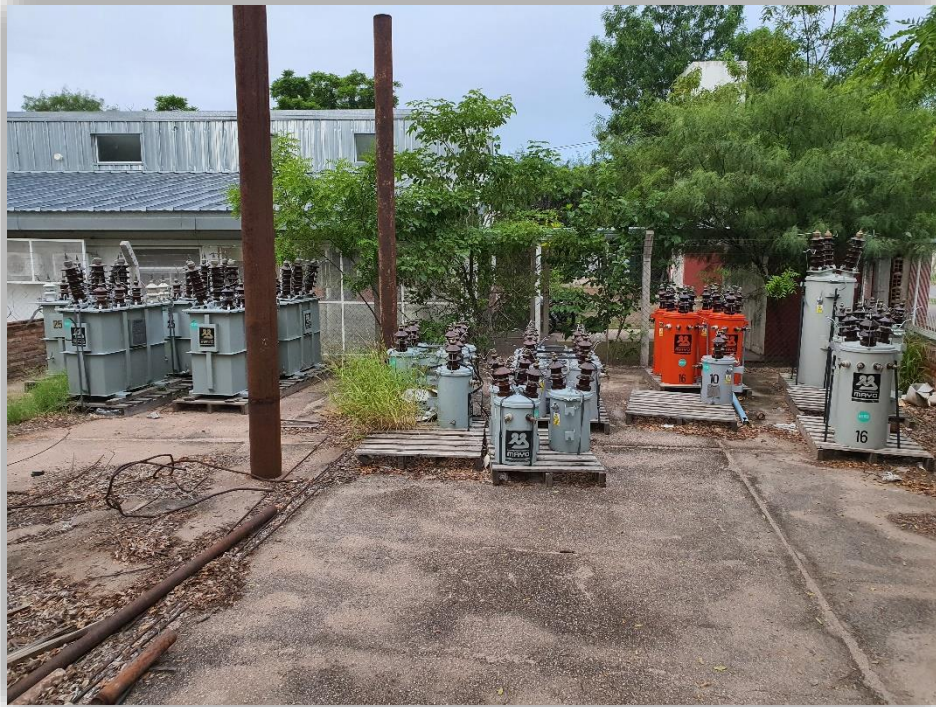
(Sector de Transformadores)
