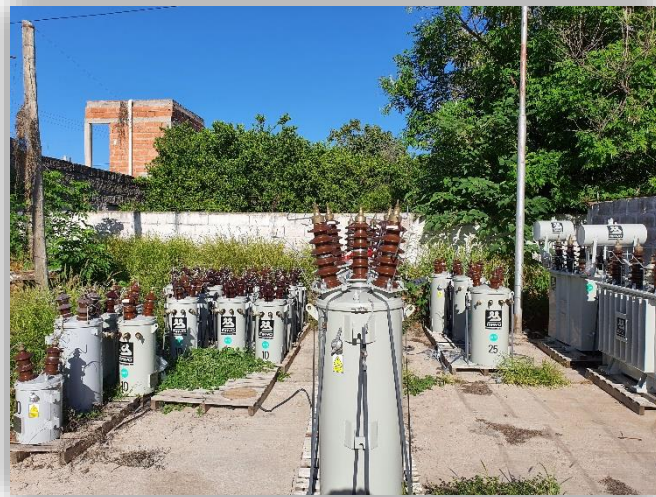
(Sector de Transformadores)
