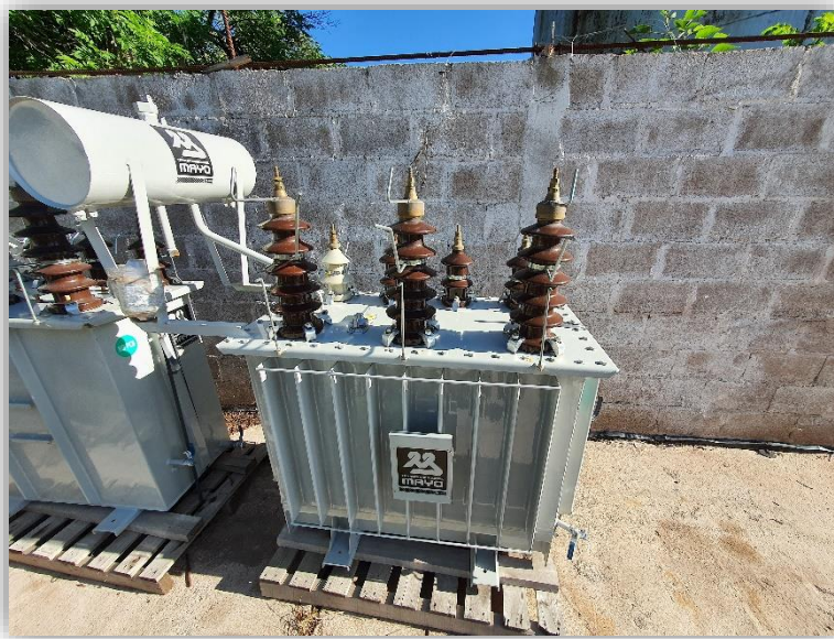
(Transformador Trifásico de 160 kVA; 33/13,86-8 kV)
