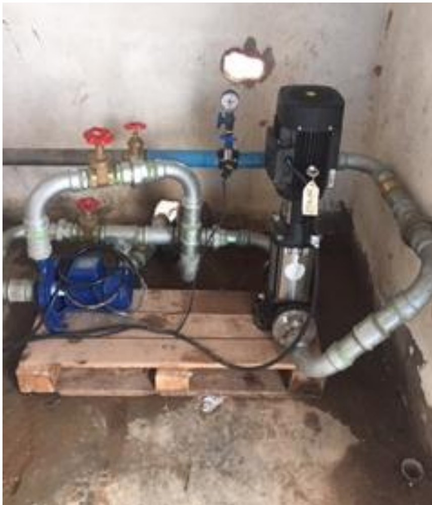
Figura 4: Bomba auxiliar, izquierda; bomba principal, derecha.
