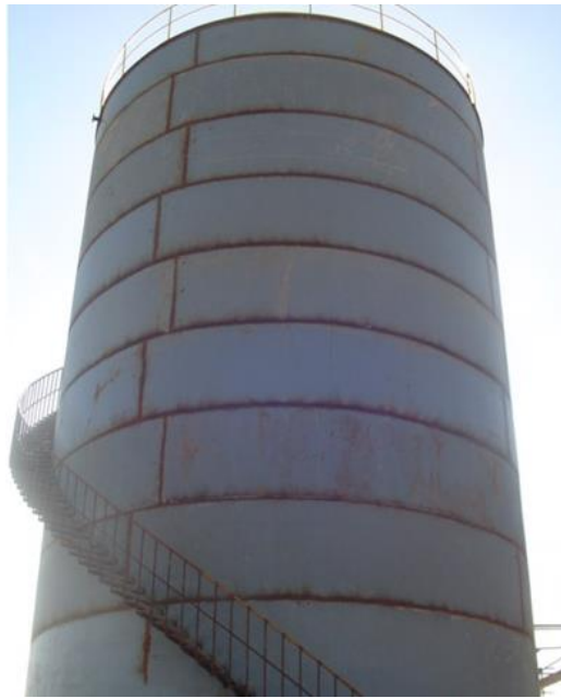
Figura 7-13. Tanque de almacenamiento de glicerol crudo (T1-a, T1-b). Fuente: SOIME S.R.L.
