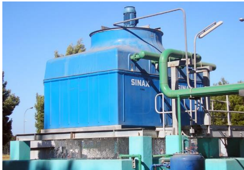
Figura 8-1. Torre de enfriamiento EWK. Fuente: SINAX
