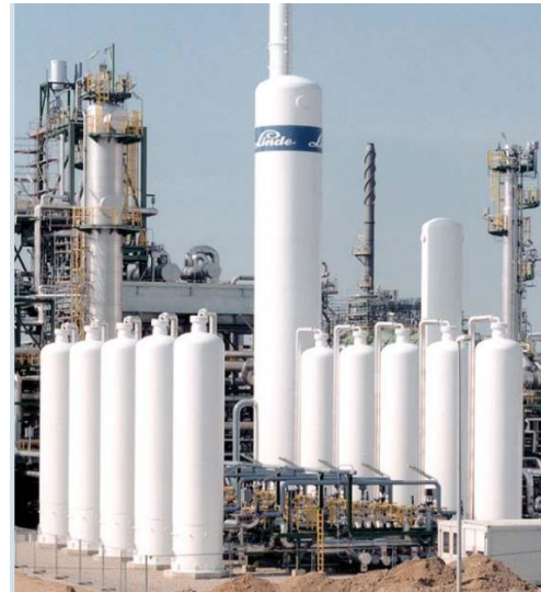
Figura 7-12. Unidades PSA para la recuperación de H 2 en una refinería en Alemania. Fuente: Linde.
