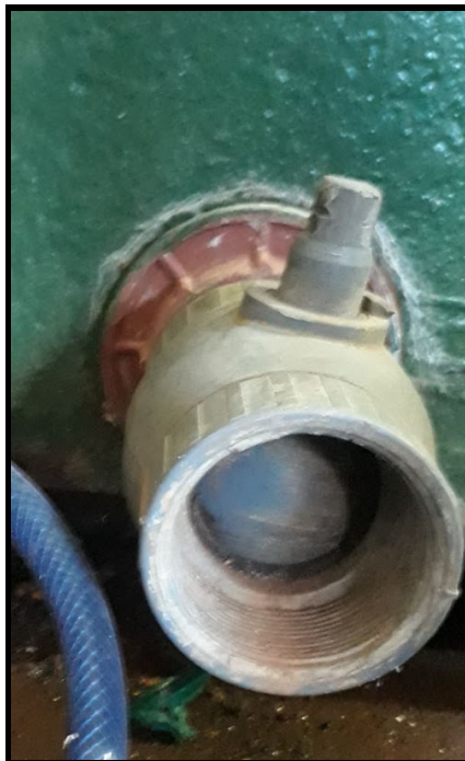
Figura 156. Válvula esférica del tanque
