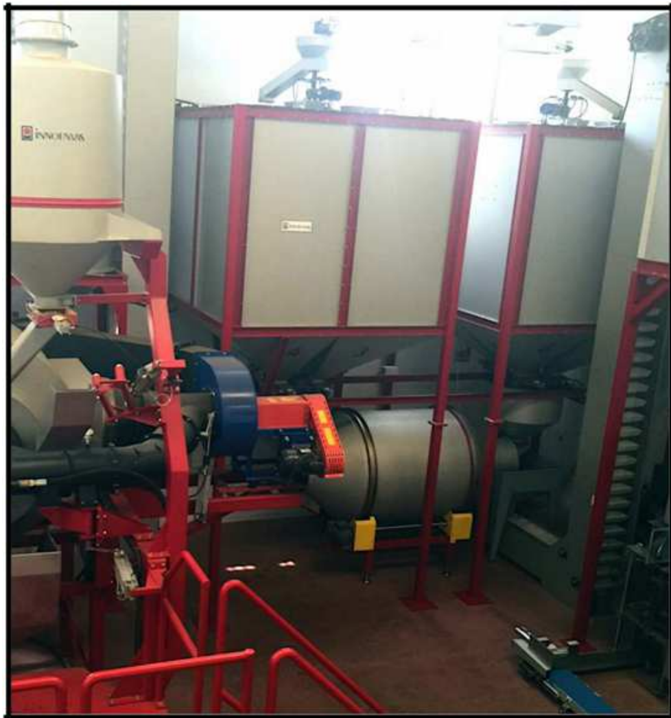
Figure 47: Silos de Pre-Molido Fuente: INNOenvas
