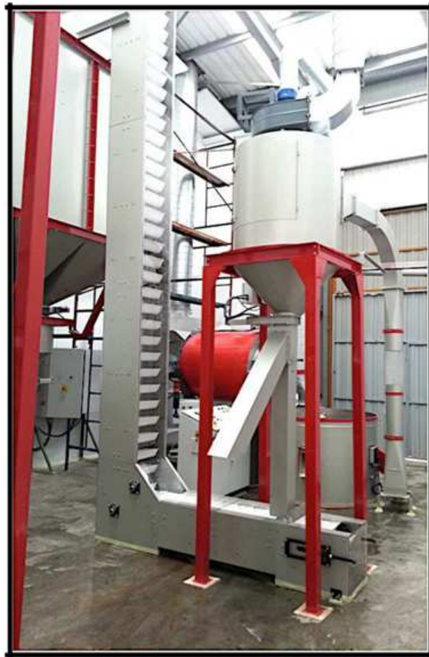
Figure 52: Elevador de Cangilones vista 1 Fuente: INNOenvas
