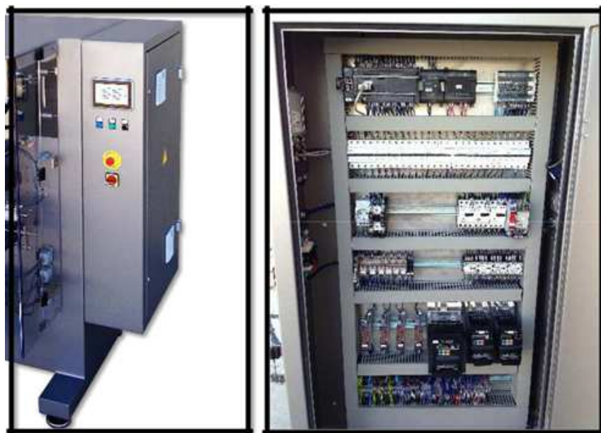
Figure 64: Cuadro eléctrico Fuente: INNOenvas
