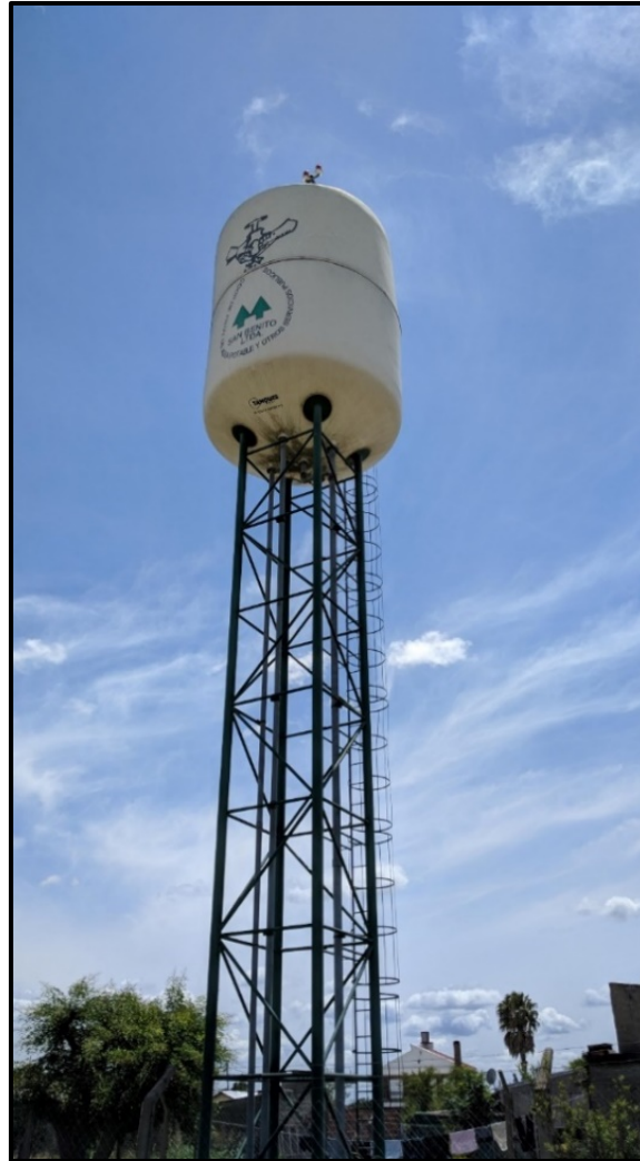
Imagen 9-2 Fotografía del tanque de agua
