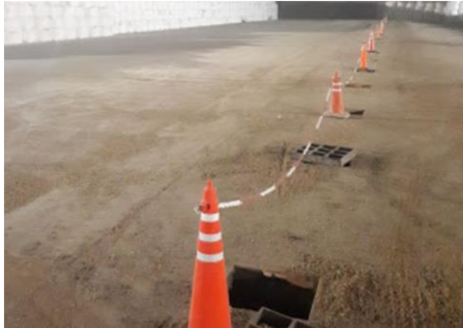
Ilustración 6 - Registros motorizados bajo celda
