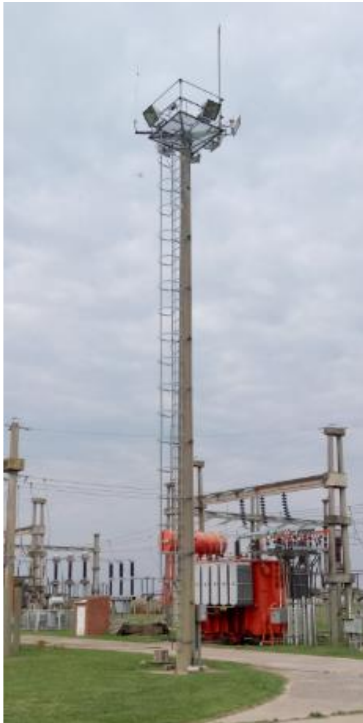
Figura 8: Torre de iluminación
