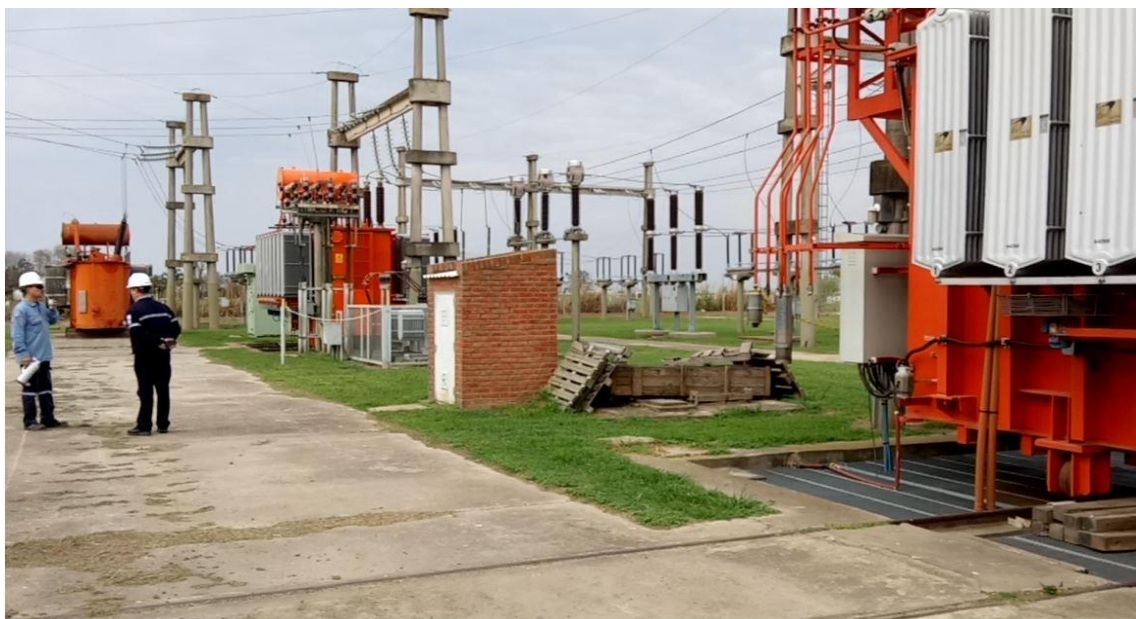
Figura 5: Transformadores de la ET
