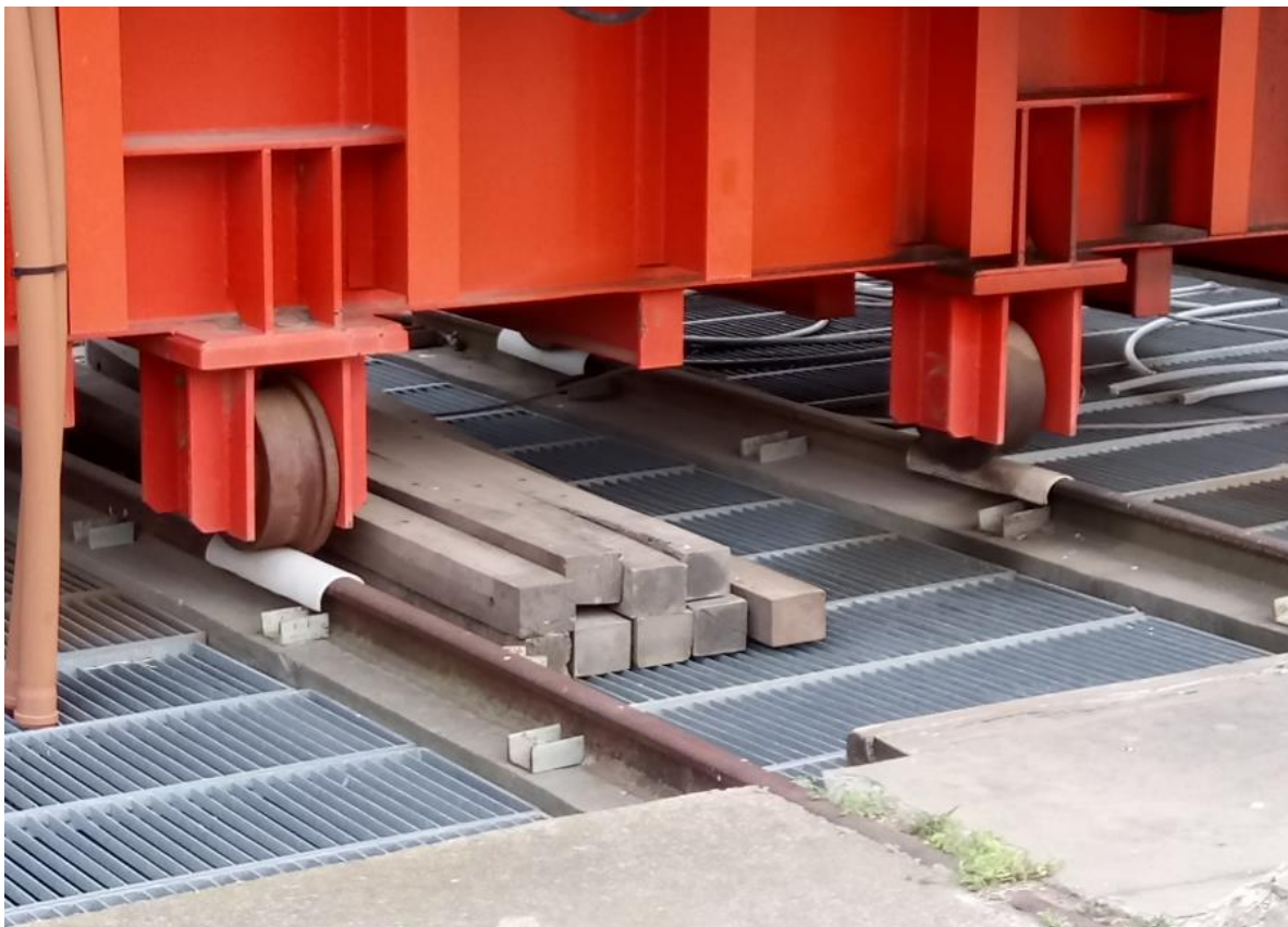
Figura 4: Aisladores en apoyos del transformador
