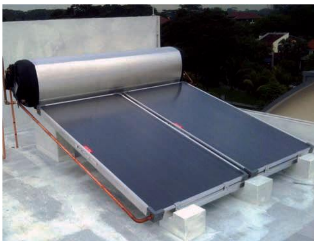
Figura 41. Termotanque de parrilla de hidrobronce (INTA)
