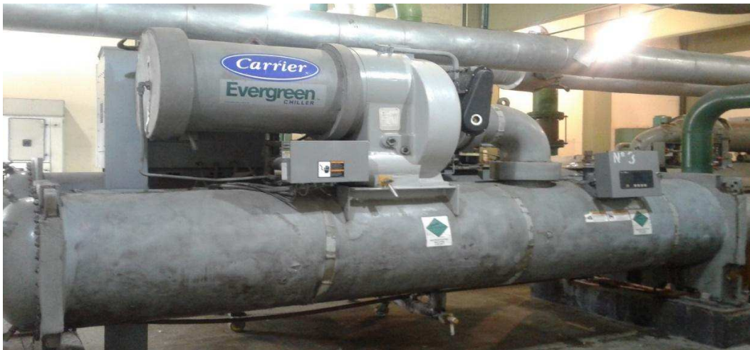
Fotografía 4.1 – Compresor para acondicionamiento marca CARRIER en la planta.
