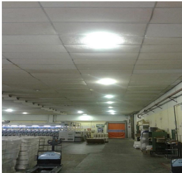
Fotografía 3.1 – Iluminación con lámparas de vapor de mercurio en la planta febril.
