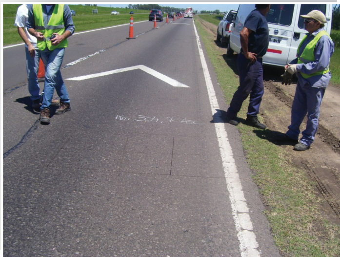
Figura 3 Reducción de carril y demarcación de calicatas previo a la apertura de calicata.
