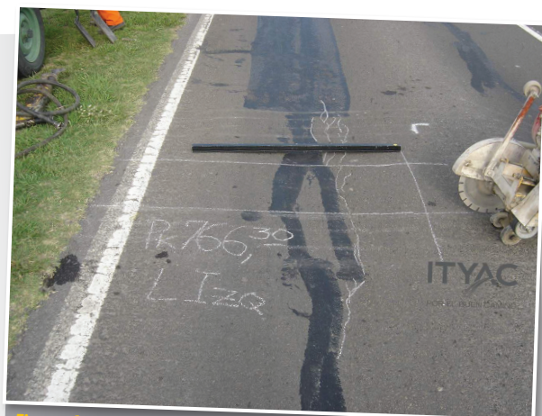
Figura 6A Demarcación e identificación de fisuras en superficie y en profundidad.
