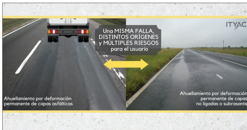
Figura 1 Formas en las cuales se puede expresar el ahuellamiento en superficie.
