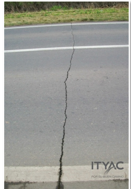
Figura 2A Fisura transversal o “térmica”.
