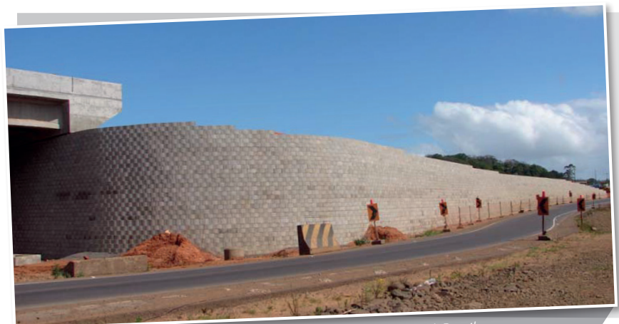
Estribo de puente en Ruta BR 101 en el estado de Rio Grande do Sul, Brasil.
