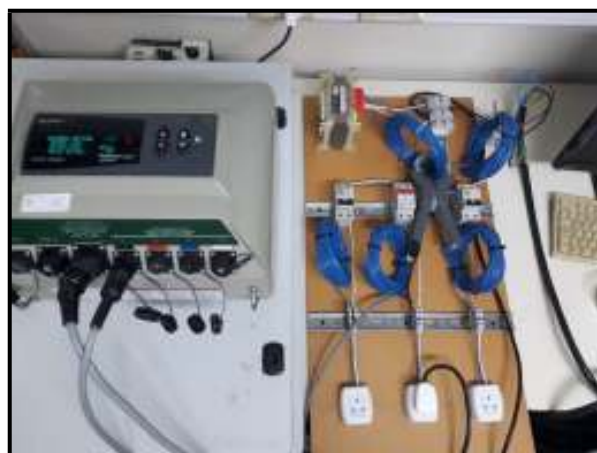
Fig. 4: Tablero de pruebas y analizador de redes Square-D PCM4000 (fuente propia).
