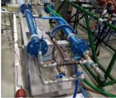
Fig. 1: Intercambiadores de calor
