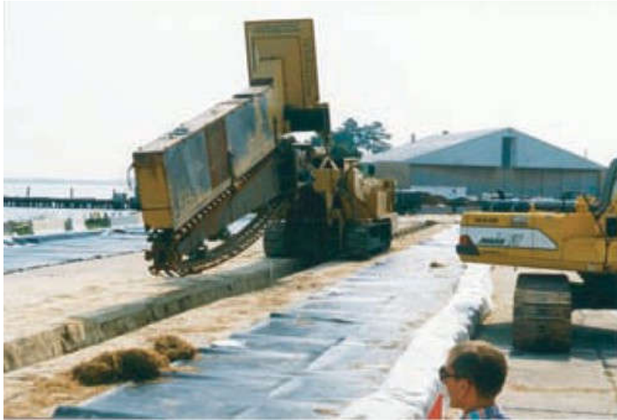
Ilustración 57: Zanjadora continua utilizada para instalar una PRB de 0,6 m de espesor y 7,3 m de profundidad (111)
