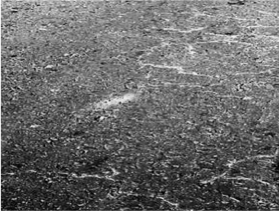
Figura 11. Fisuras entrelazadas en pavimento asfáltico, con afloramiento de material pulverulento (Fotografía de los autores)
