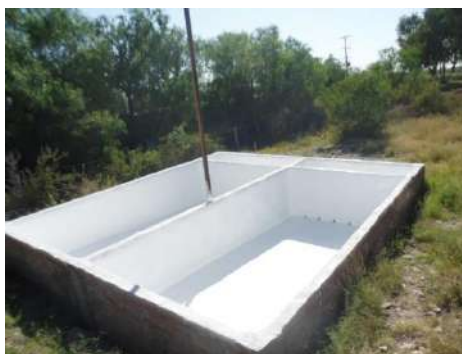
Figura 1 Izq.: Vista de las piletas y su conexión a cámaras colectoras. Der.: Vista del
