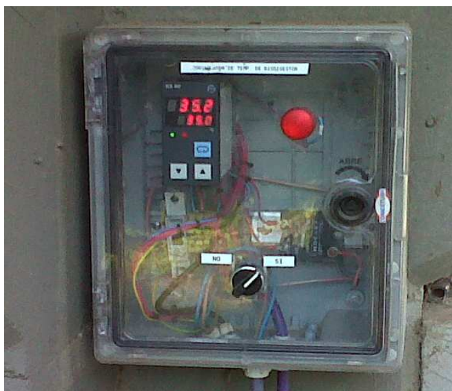
Fig. N ° 10 – Tablero control de temperatura
