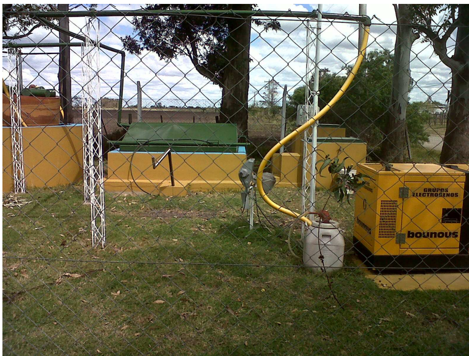
Foto 7 – Grupo electrógeno y filtro. Planta N° 2 Pueblo Moreno (Cerrito, Paraná)
