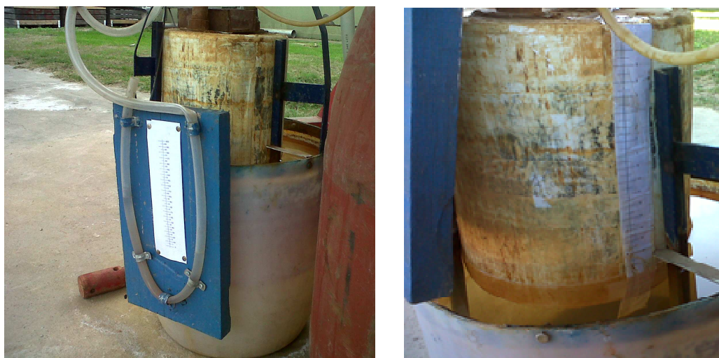
Figura 14. Manómetro columna de agua y gasómetro
