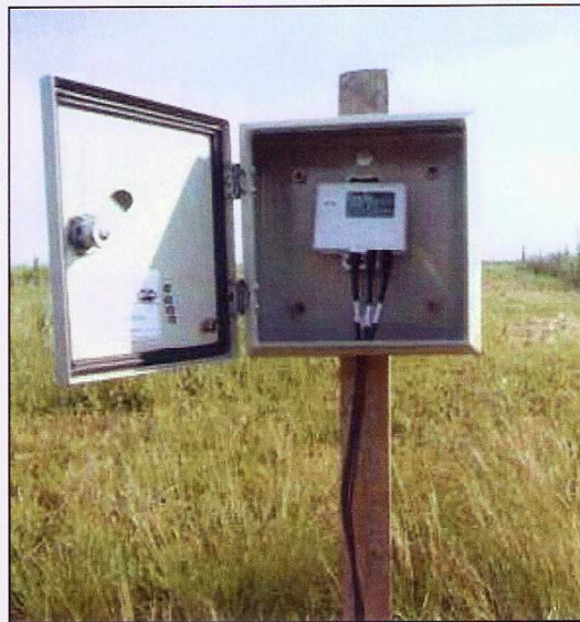
Imagen 20. Datalogger en caja metálica
