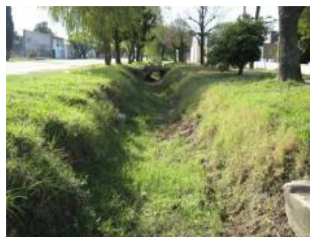
Fig. N° (6-2) - 4 Vegetación crecida en los canales
