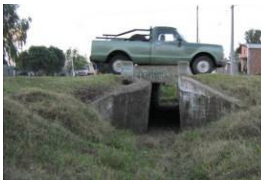
Fig. N° (6-2) - 2 Alcantarilla derrumbada
