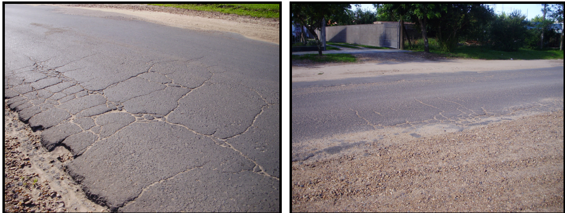
Figura IV-26 - Fisuración formando panes pequeños (piel de cocodrilo)
