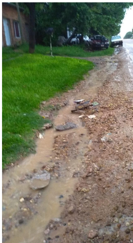
Ilustración 2.24 | Rotura de calle Alberdi, entre Conte Grand y Piamonte
