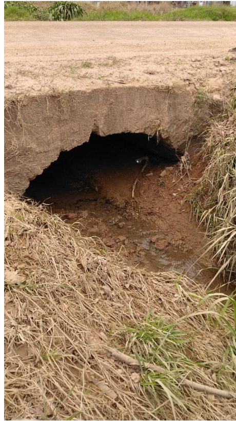
Ilustración 2.11 | Entubado obstruido en Alberdi
