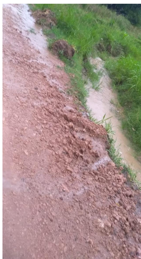
Ilustración 2.25 | Deterioro en bulevar Cabo Pereyra
