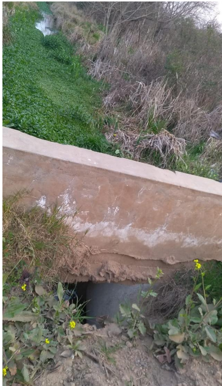
Ilustración 2.12 | Rotura de entubado en Paysandú, entre Vergniaud e Illia
