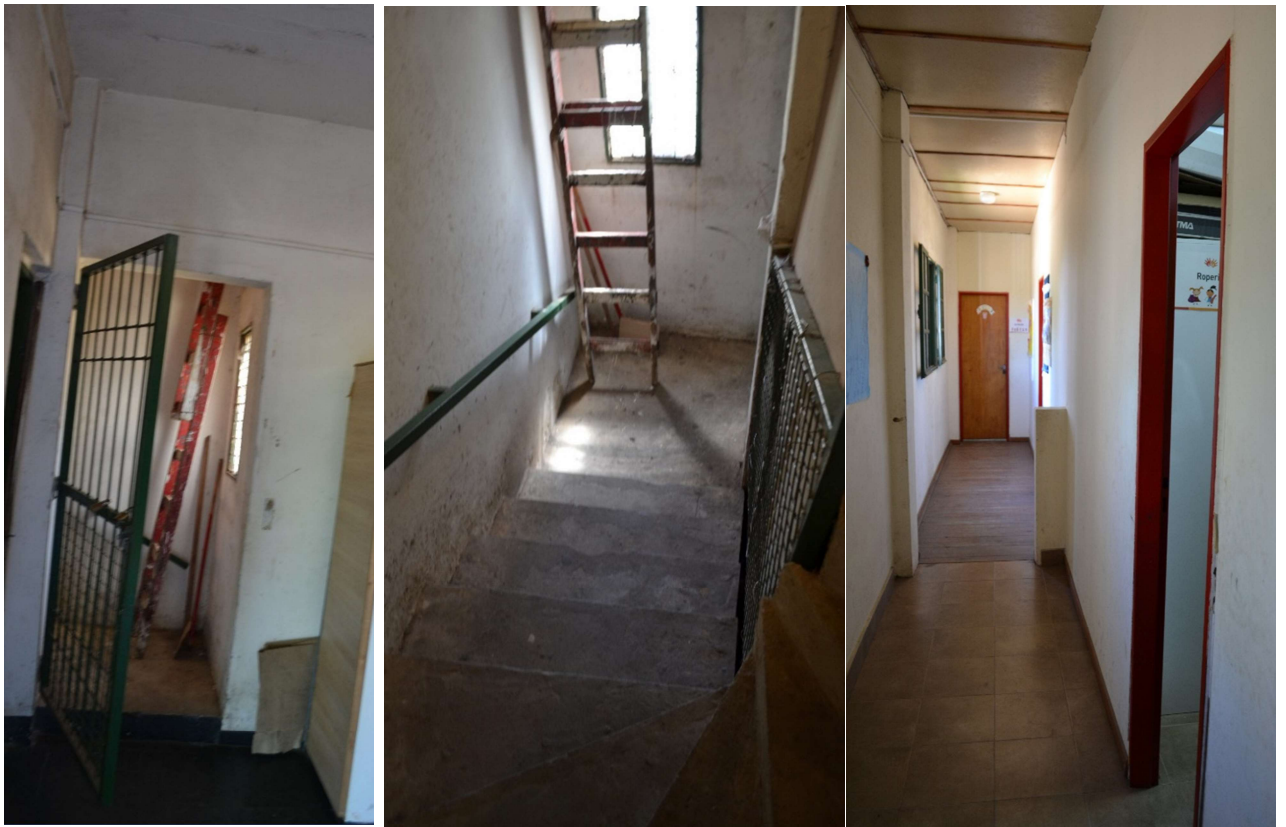
Ilustración 14 - Puerta de acceso a escalera - Escalera vista desde el primer piso - Pasillo de primer piso visto desde fin de escalera. -
