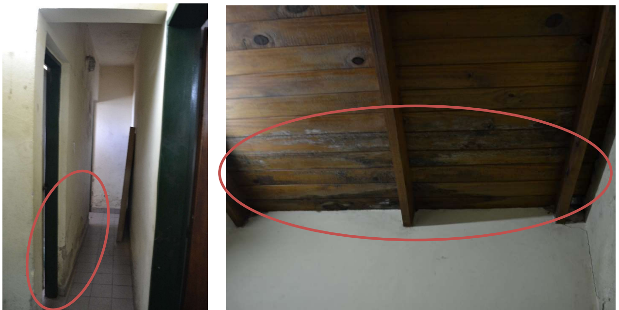
Ilustración 21 – Muros y cielorrasos con presencia de humedad producto del agua.
