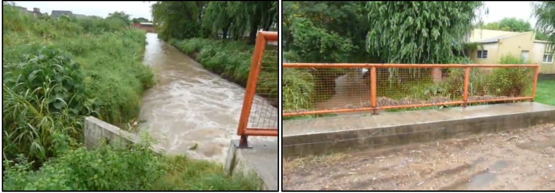
Figura 4.2 - Alcantarillas desbordadas por el nivel del arroyo. Fuente: Youtube.
