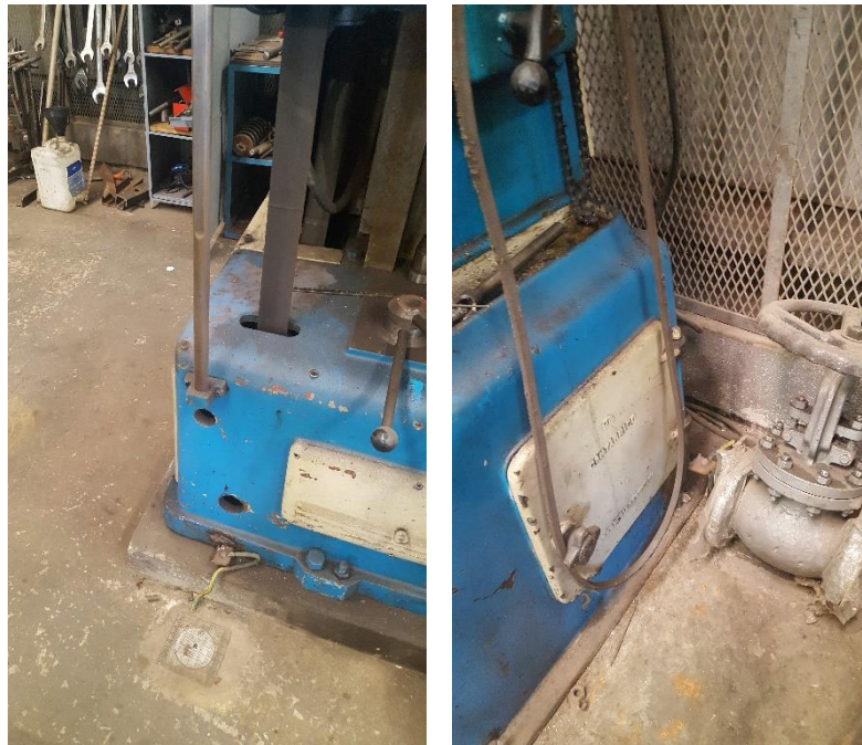
Máquinas con PAT desconectadas
