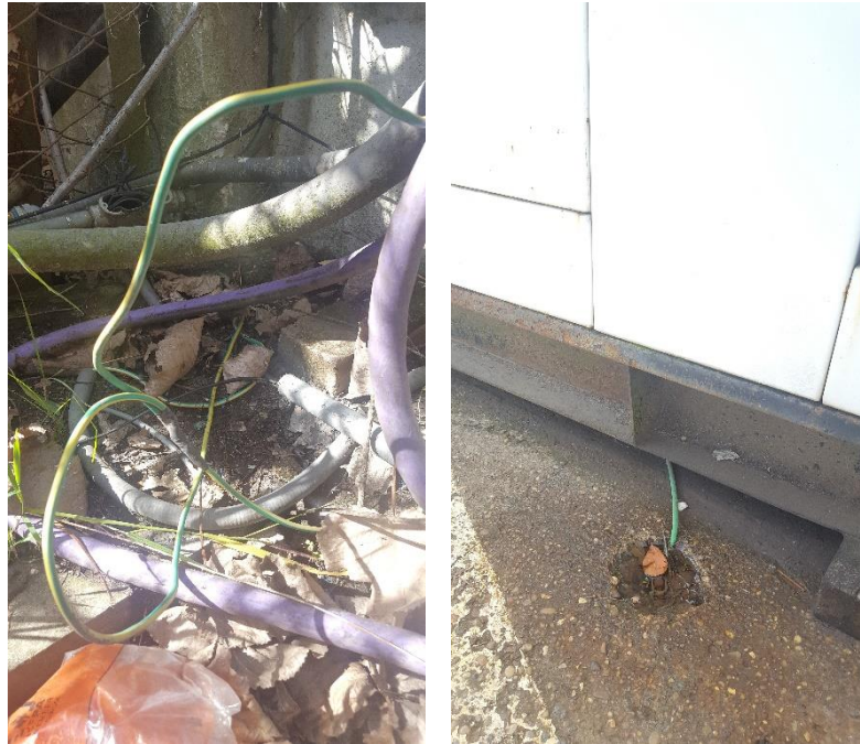
Jabalinas sin cajas de inspección reglamentarias
